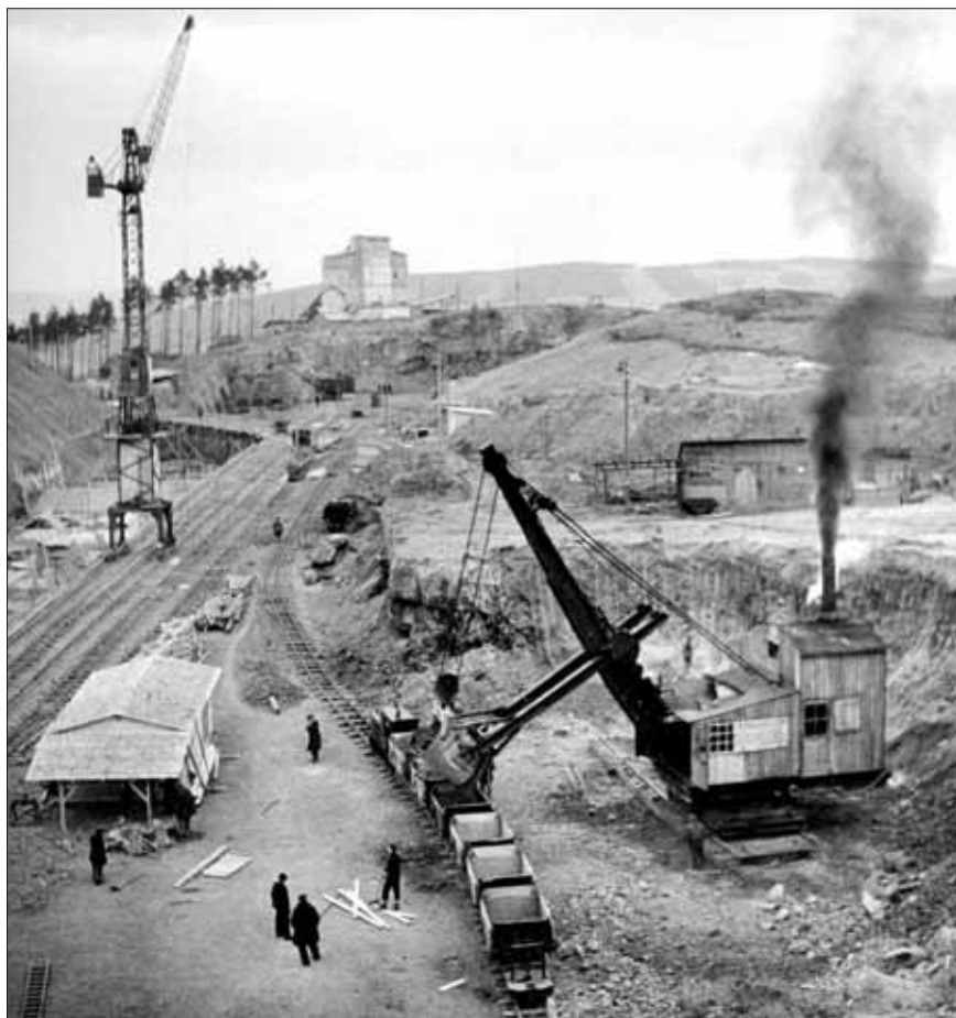
Na fotografii L. Votruby z ledna 1943 vidíme na stavbě horní nádrže štěchovické přečerpávací elektrárny (firmy Domanský a Kress) stroje všech trakcí: elektrický věžový jeřáb, motorovou lokomotivu a parní rypadlo, vypůjčené od firmy Lanna.
