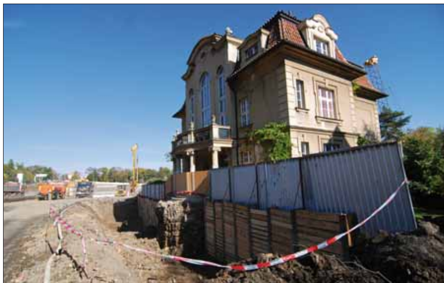
U objektu č. p. 712 nemohlo být provedeno kvůli stísněným podmínkám záporové pažení; to bylo nahrazeno tryskovou injektáží, podchycující jeho základy.
