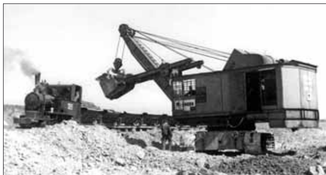
Na tovární fotografii Škodovky z počátku 40. let je zachycena na stavbě u Brna lokomotiva ČKD a rypadlo Škoda s lopatou 1 m 3 ; oba stroje nesou označení majitele – německé stavební firmy Funke & Co. ze saského Freitalu.
