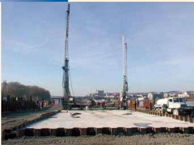
Provádění injekčních prací z betonové plošiny, zhotovené na celé ploše vnitřní stavební jímky
