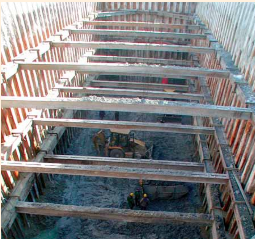
Zemní práce ve stavební jímcce pro založení mostního pilíře č. 10 v úrovni základové spáry, jež je tvořena horní hranou proinjektované oblasti podloží pilíře tryskovou injektáží
