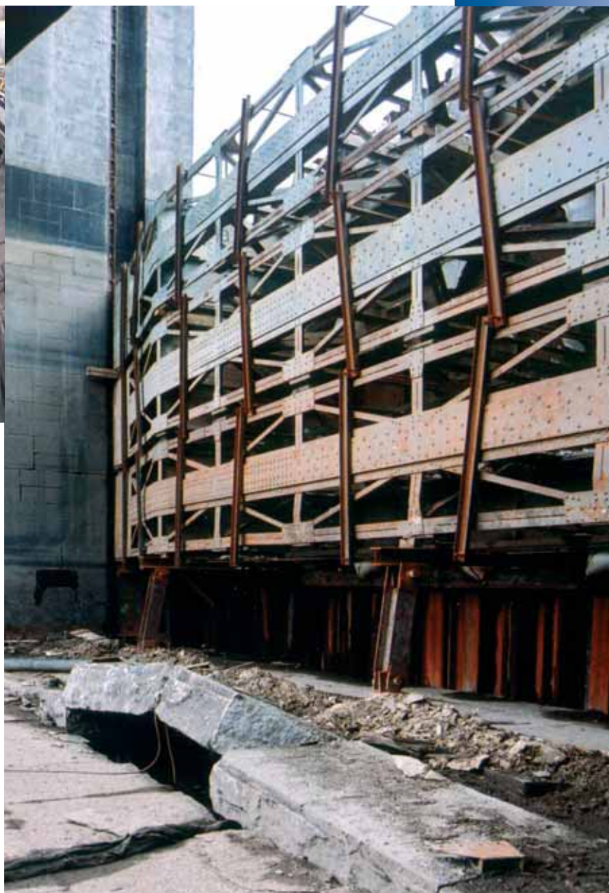
Vertikální deformace původní konstrukce jezového pole byla až 65 cm, v pozadí originální řešení havarijního hrazení zájmového prostoru
