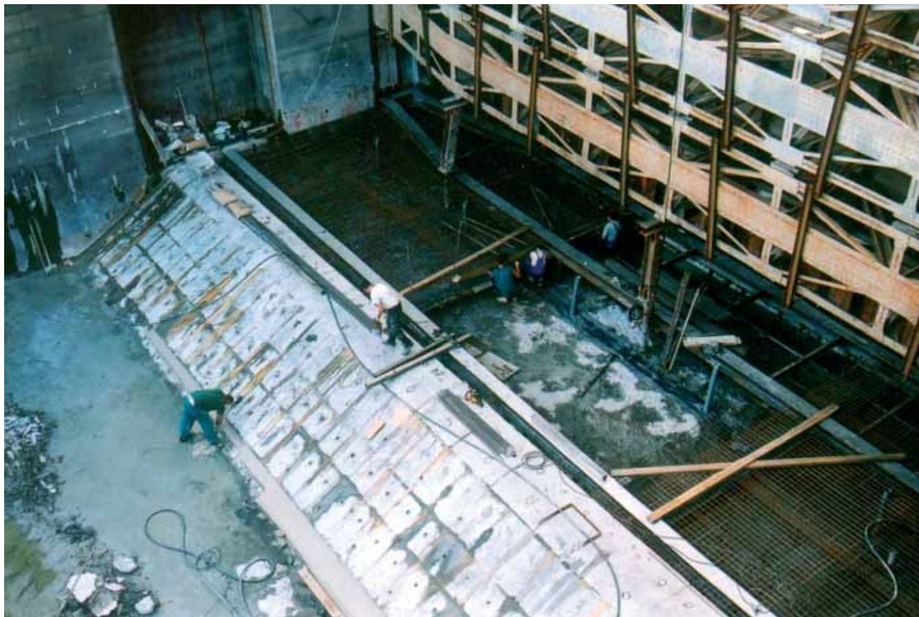
Pohled do vyčerpaného prostoru hlavního jezového pole při kladení výztuže nové železobetonové desky
