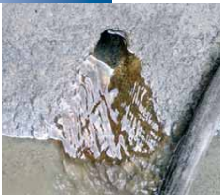
Voda vyvěrající z vrtů pro kotvení konstrukcí
