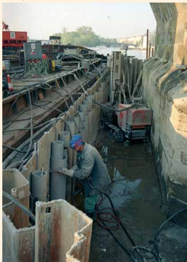
Práce v prostoru vyčerpáné jímky mezi pilířem a uzavřenou ochrannou obálkou před realizací žlb. věnce
