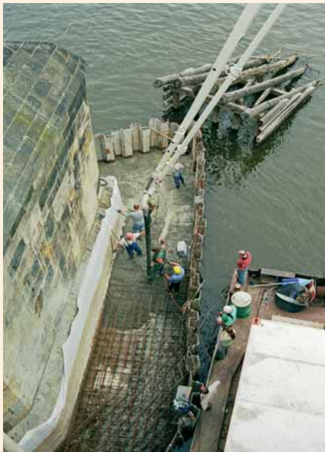
Betonáž žlb. věnce z betonu C25/30-XA1, který nově vybudovanou ochrannou obálku uzavřel shora
