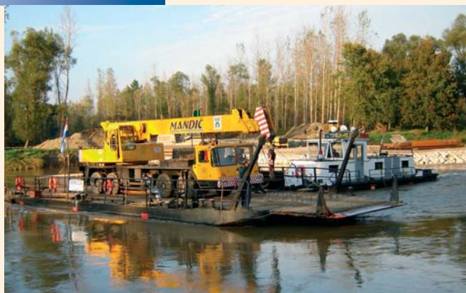
Sv. Martin na Muri – příprava na beranění štětové jímky pro mostní pilíře a dočasné ocelové podpory pro montáž mostu.
