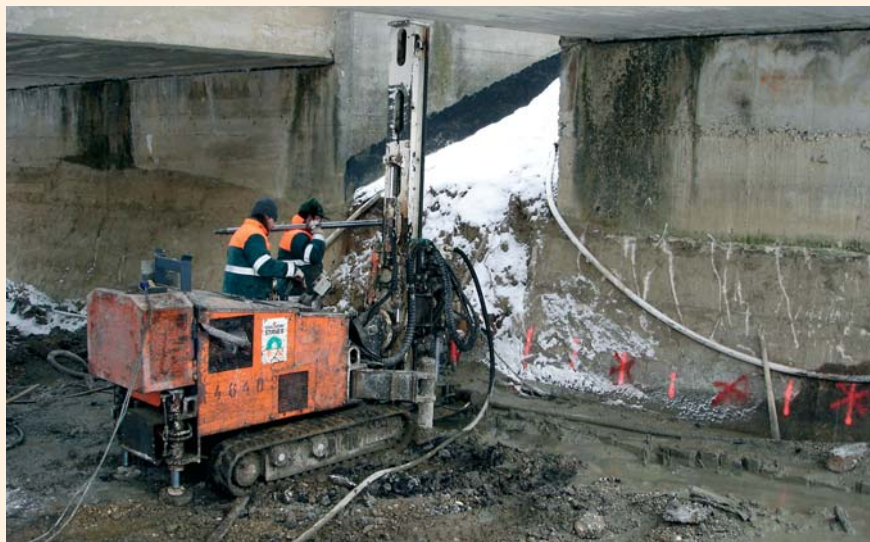
Stavba nového kanalizačního systému města Záhřeb, podchycování základů železničních mostů metodou tryskové injektáže
