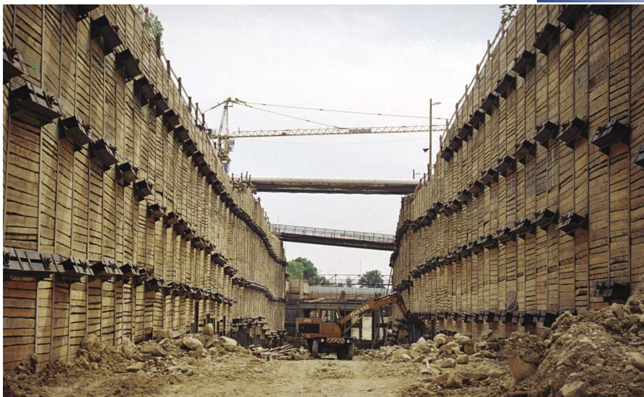
SO 11, v konečné fázi výkopu zde hloubka stavební jámy bude dosahovat až 18 m
