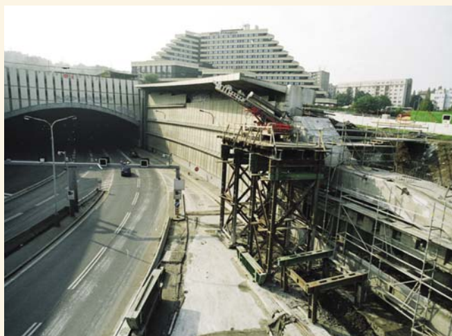
Přemostění výjezdu ze Strahovského tunelu na Malovance v Praze Přikotvení závěrné zdi trvalými pramencovými kotvami v souvislosti s plánovaným novým přemostěním výjezdu z tunelu.
