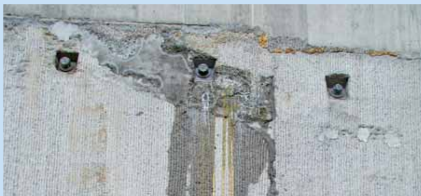
Obr. 2: Zjištěné imperfekce v blízkosti kotevní průchodky v lamelách podzemních stěn
