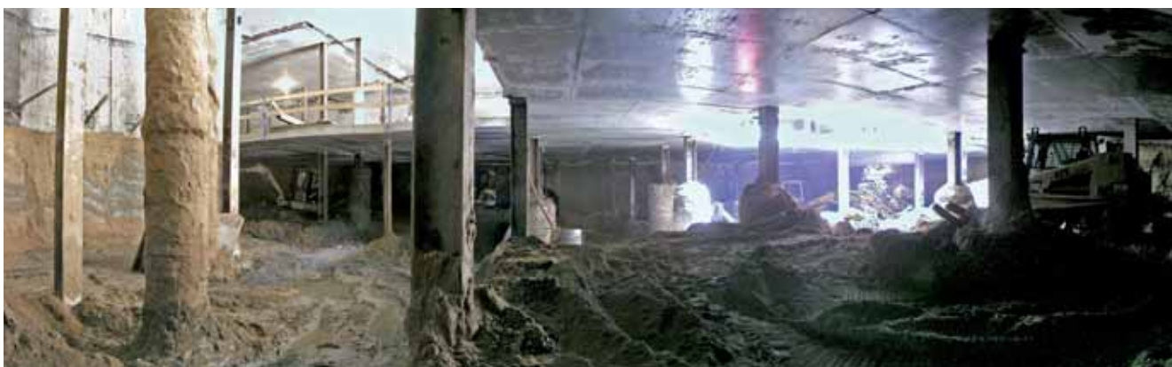
Panoramatický pohled v úrovni suterénu 4. PP. Vidíme zde betonové piloty prům. 600 mm pro založení jeřábu a definitivní ocelové sloupy s obnaženými hlavami základových pilot (vzadu).
