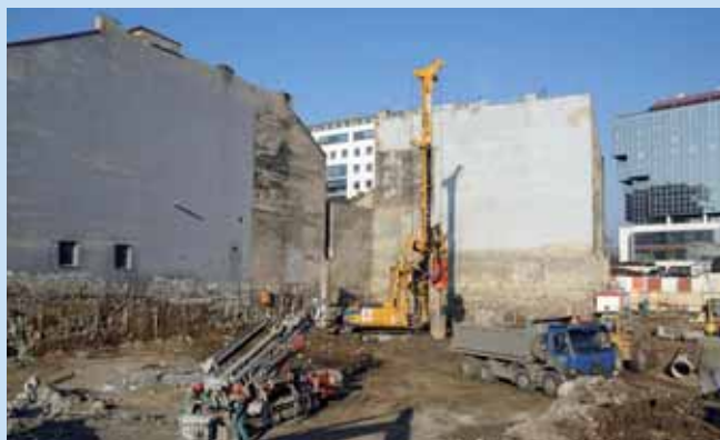
Hloubení vrtů pro piloty v rohu mezi objekty č. p. 304 a 240 ve snížené části staveniště
