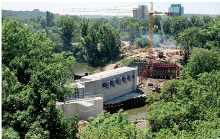
Pohled na přečerpávací stanici před dokončením
