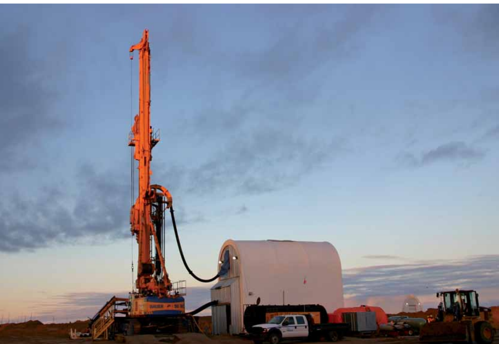
Obr. 1: Vrtná souprava se samostatně vybudovaným a vytápěným zařízením pro vibrosíta
