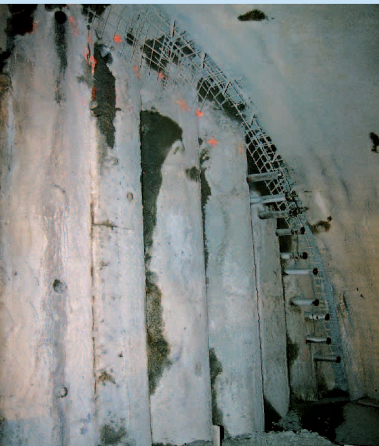
Odtěžená přepážka převrtávané pilotové stěny na úrovni 1. lávky během provádění mikropilotového deštníku
