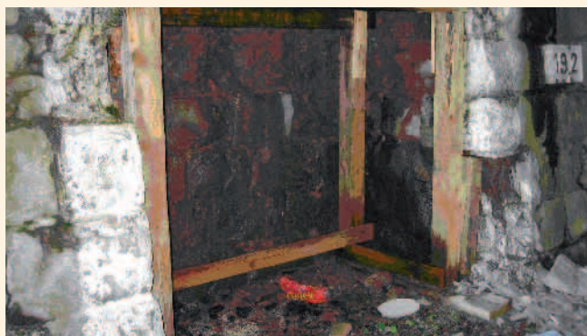
Příklady zaznamenaných pozorování (poškození ostění)
