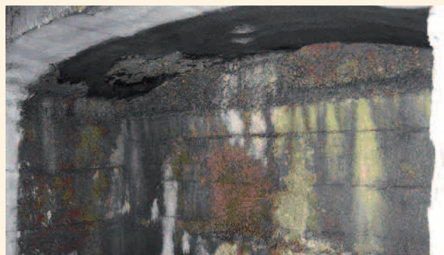
Poškození nouzového výklenku tunelu
