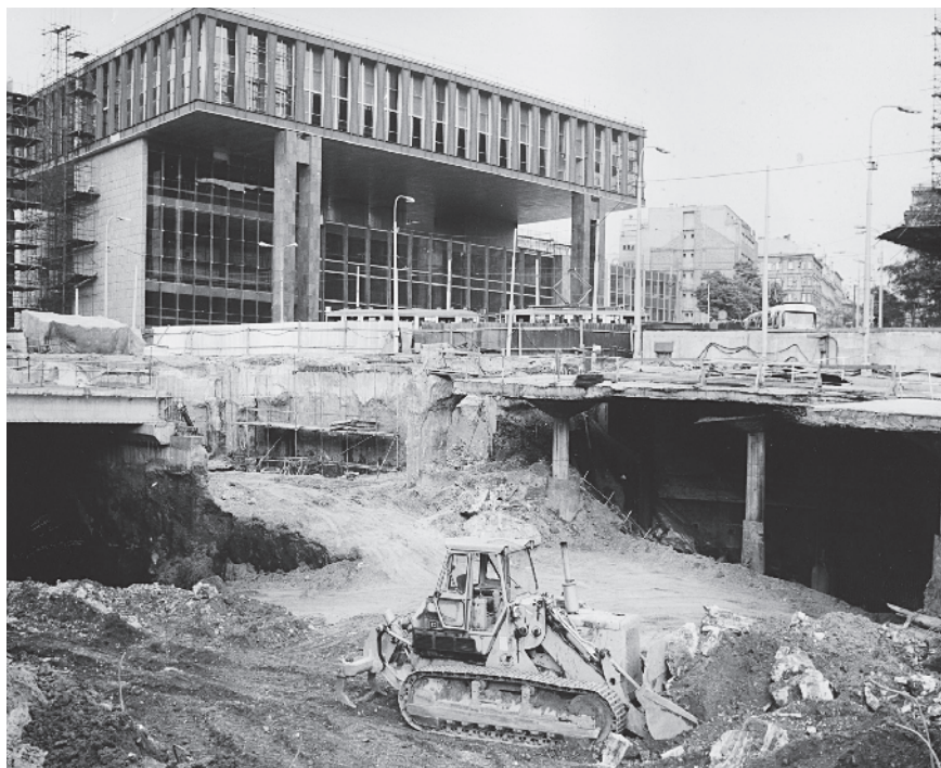
Pohled na tunely metra u budovy Národního shromáždění a Národního muzea, kde byly železobetonové stropy tunelů uloženy na konstrukční podzemní stěny. To umožnilo zkrátit výluku dopravy v místě stavby, protože prostor tunelů byl těžen již pod ochranou osazených stropů, na kterých byl obnoven povrchový provoz. Z obrázku je patrná výztuž a betonáž stropů podzemních podlaží, které byly vyztuženy armovacími sítěmi a kruhově uspořádanou výztuží kolem nosných sloupů (Winschova výztuž stropů)
