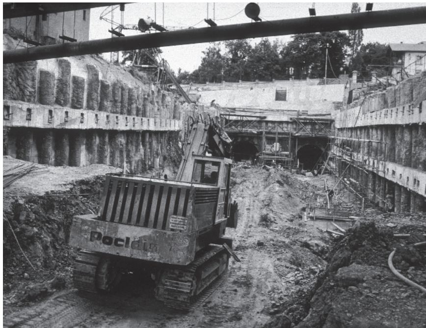
Stavební jáma pro stanici Kačerov na trase metra C1, pohled na portálovou stěnu tunelů. U portálu nebylo možné pilotové stěny kotvit, a proto byly zajištěny rozepřením šikmými ocelovými trubními rozpěrami (1971).
