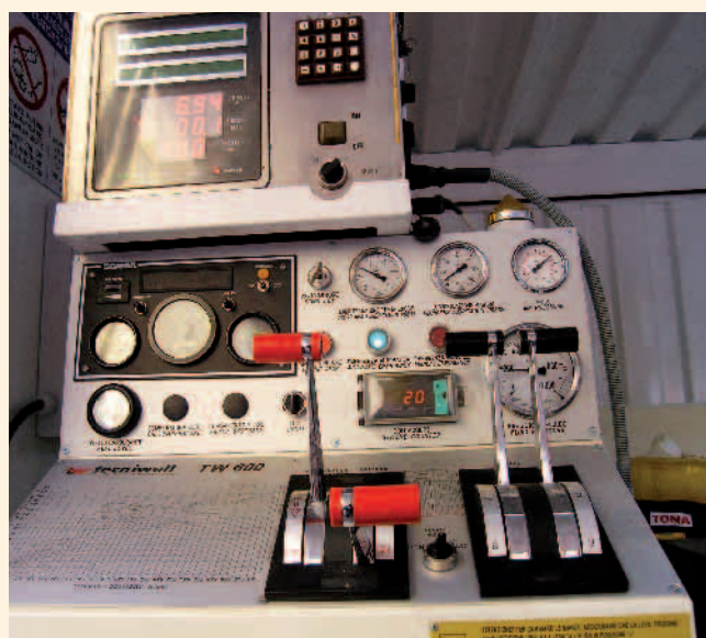
Pohled na řídicí pult injekčního čerpadla s monitorovací soupravou MP8A
