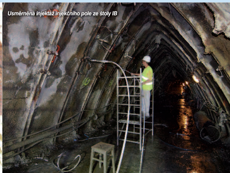
Vrtná souprava MVS 741/20 s upravenou kinematikou vrtné lafety při provádění dovrchních vrtů v průzkumné štole IB
