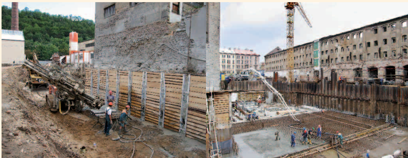
Kotvení zápor instalovaných v těsnicí stěně ze samotrdnoucí suspenze u objektu garáží Stavební jáma při betonáži základové desky
