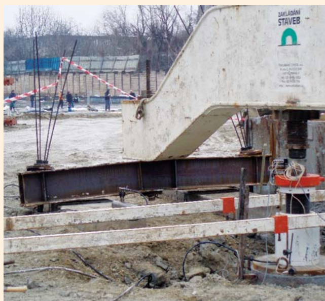
Pohled na deformující se příčník a na referenční most pro měření deformací
