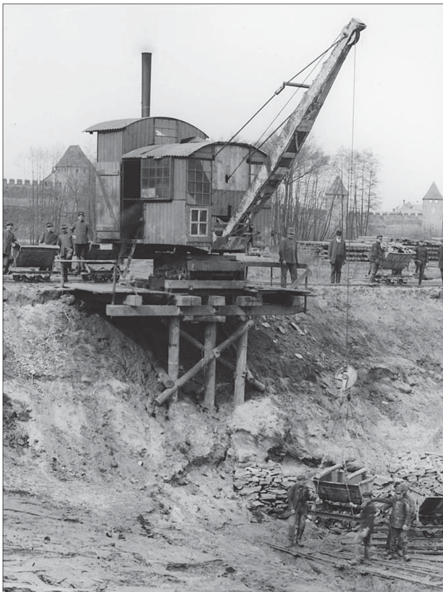
Při stavbě zdymadla v Nymburce firmou Lanna převzalo na jaře roku 1916 roli jeřábu parní lopatové rypadlo Menck-Hambrock, jehož lopata byla dočasně odmontována.
