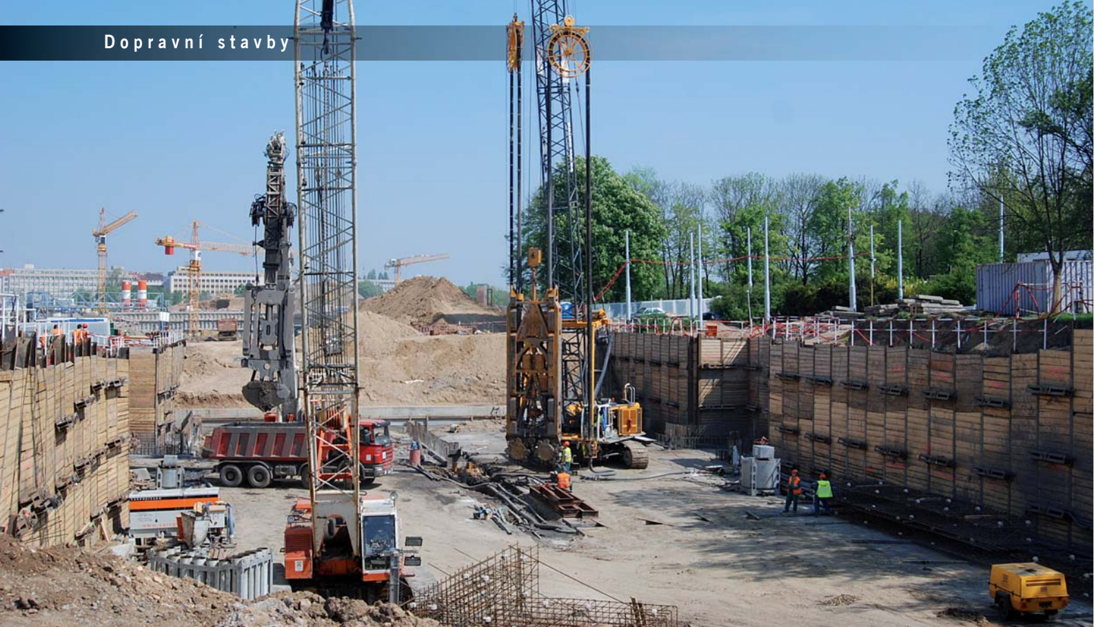
Stavební jáma pro výstavbu dilatací 9, 10, 11, realizovaných v konstrukčních podzemních stěnách, zajištěná kotveným záporovým pažením během těžby podzemních stěn.
