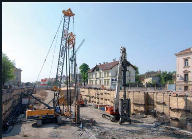
Realizace konstrukčních podzemních stěn z úrovně zapaženého předvýkopu v pohledu od Letné směrem ke Špejcharu
