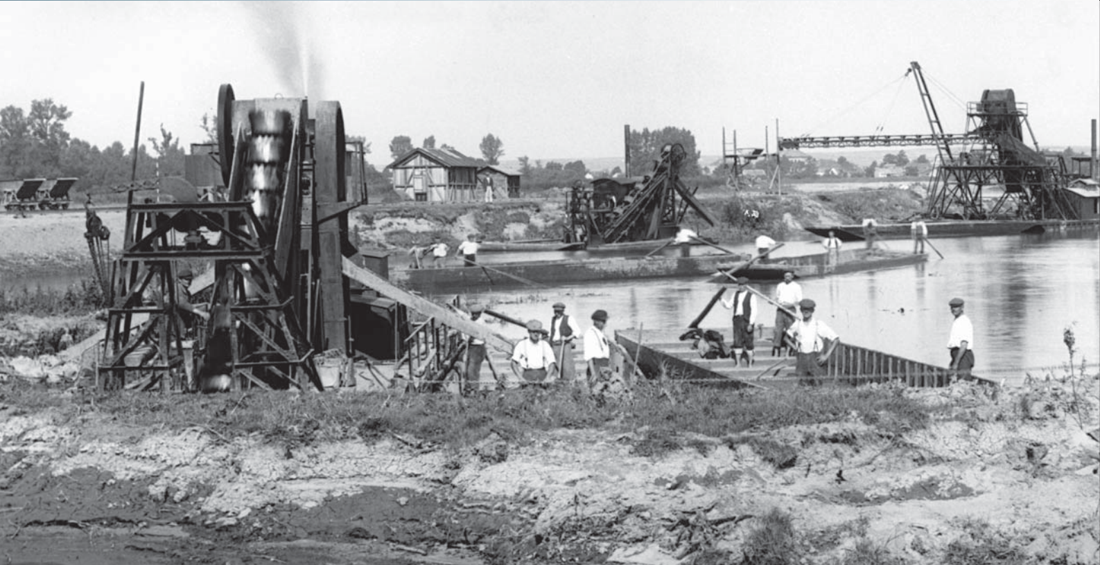
Tak vypadala část staveniště úpravy Labe Jiřice – Kozly firmou Kruliš v září 1924: elevátor (na snímku vpravo) je připraven vykládat materiál od dvou bagrů z člunů do vozíků polní dráhy.
