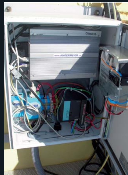
Obr. 8: Průmyslový počítač s nainstalovaným řídicím programem Observer
