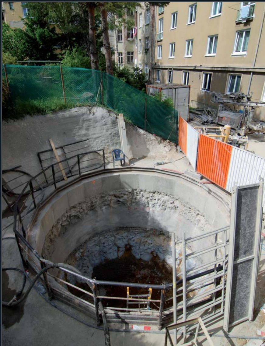
Obr. 13: Pracoviště pro kompenzační injektáž byla navržena a realizována maximálně úsporně s ohledem na zatížení okolí stavby
