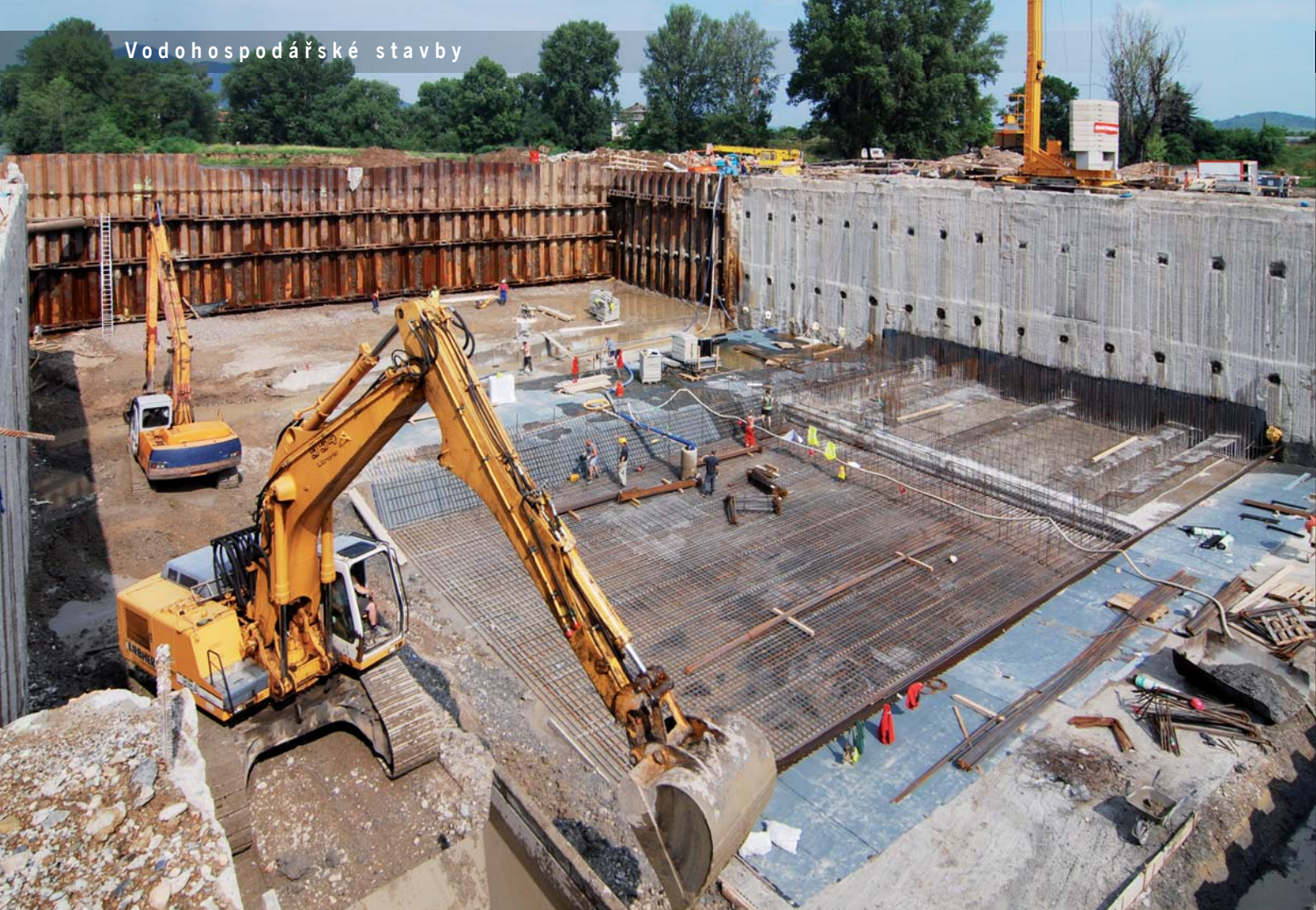
Pohled do stavební jámy od pilíře jezu během provádění základové desky strojovny
