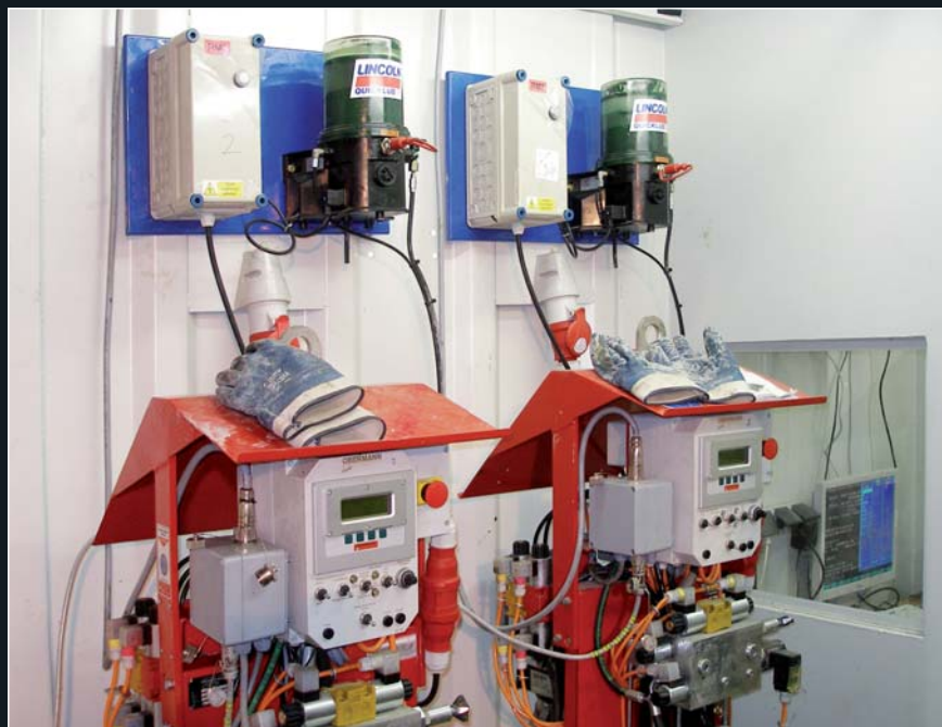
Obr. 12: Pohled na část injekční stanice Obermann, která flexibilně zvládala požadavky na proměnná zadání injektážních parametrů
