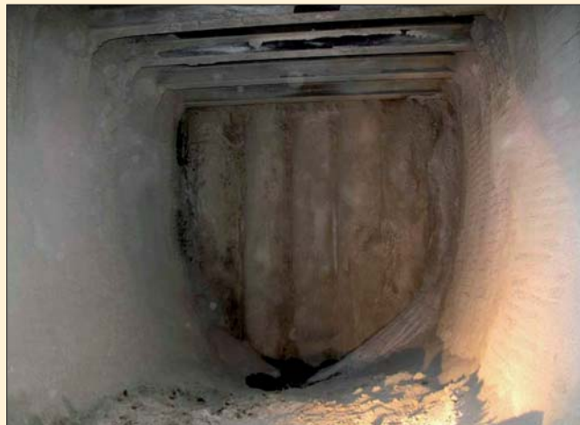
Příčná clona objektu C 618 tvořená nearmovanými pilotami na sraz, fotografováno během ražby tunelu I
