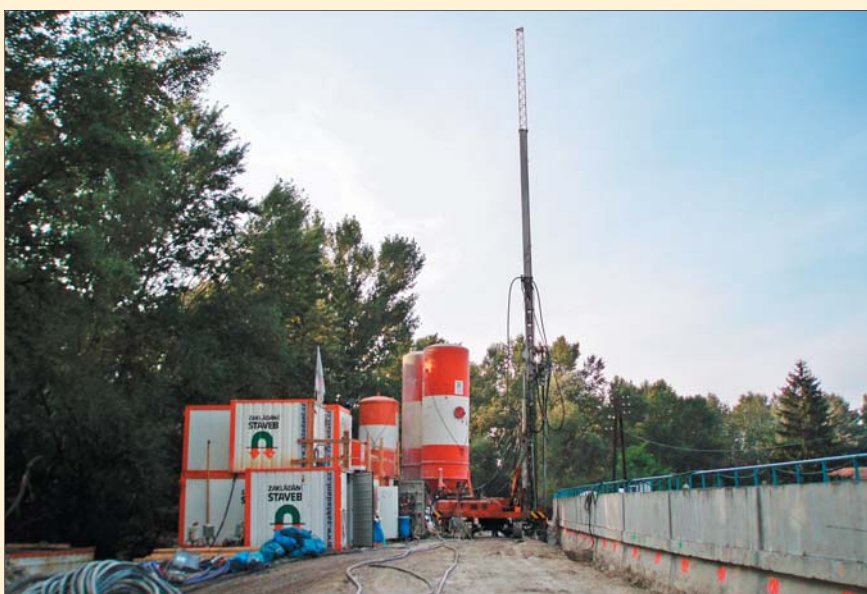
Zařzení staveniště s vrtnou soupravou HBM 150 při realizaci 2. fáze clony z lamel tryskové injektáže
