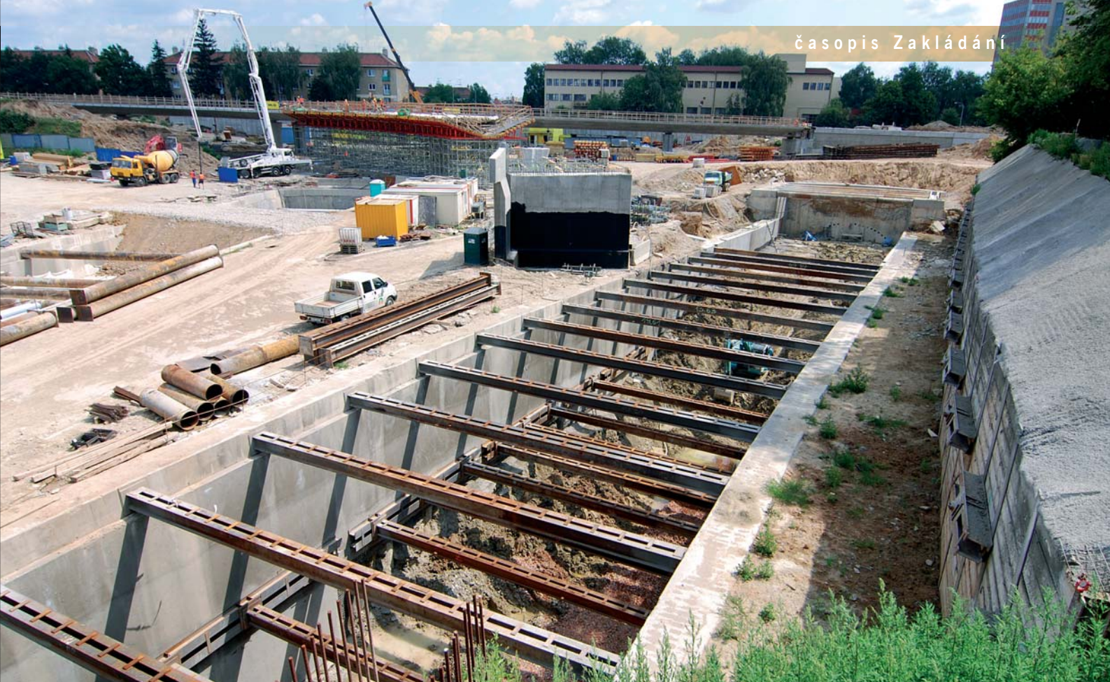
Rozeptřené pilotové stěny pro tunel II a přilehlý svah zajištěný kotvenou záporovou stěnou
