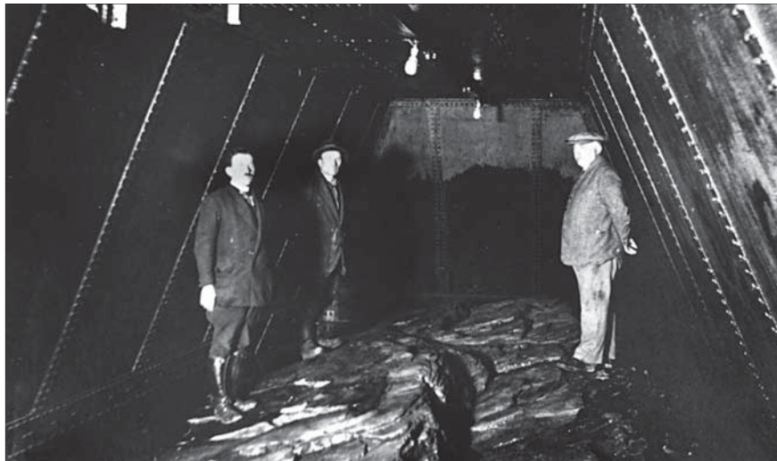
Vnitřek nýtovaného kesonu o půdorysu 4x15 metrů na stavbě střekovského jezu poté, co se 3. 5. 1927 po odtěžení několikametrové vrstvy písku a balvanů odhalilo skalnaté dno Labe
