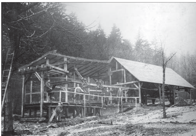
Koncová stanice lanovky pro dopravu materiálu k budované přehradě Janov u Mostu, kterou stavělo konsorcium firem Berndt, Schwarzer a Wurm.
