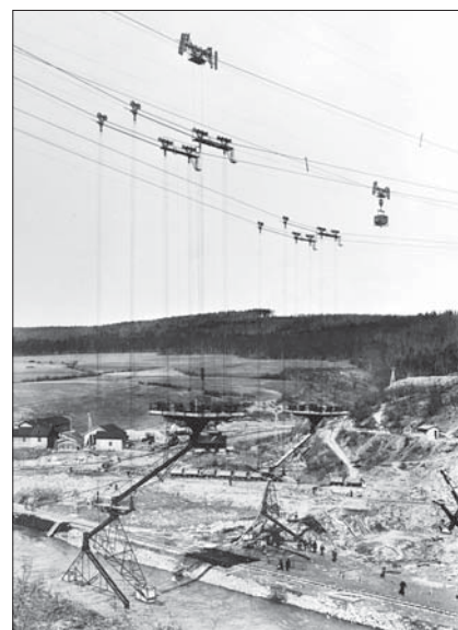
Při stavbě přehrady ve Vranově nad Dyjí se při betonáži hráze používaly dva kabelové jeřáby Bleichert (5 t, 370 m), doplněné dvěma zavěšenými licími plošinami pro distribuci betonu
