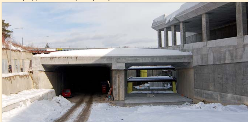
Definitivní portál z podzemních stěn, vpravo navazuje galerie objektu C 211, založená na velkopřůměrových pilotách
