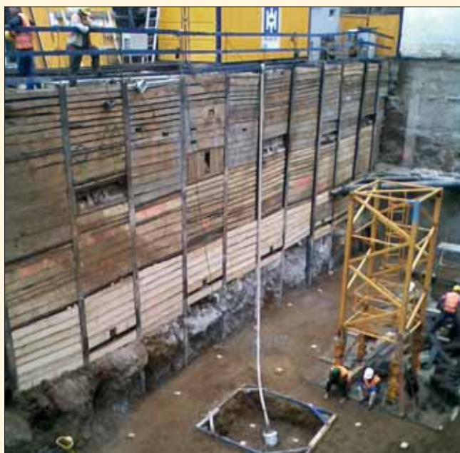
Definitivní výkop stavební jámy, záporové pažení je ve spodní úrovni těsně tryskovou injektáží
