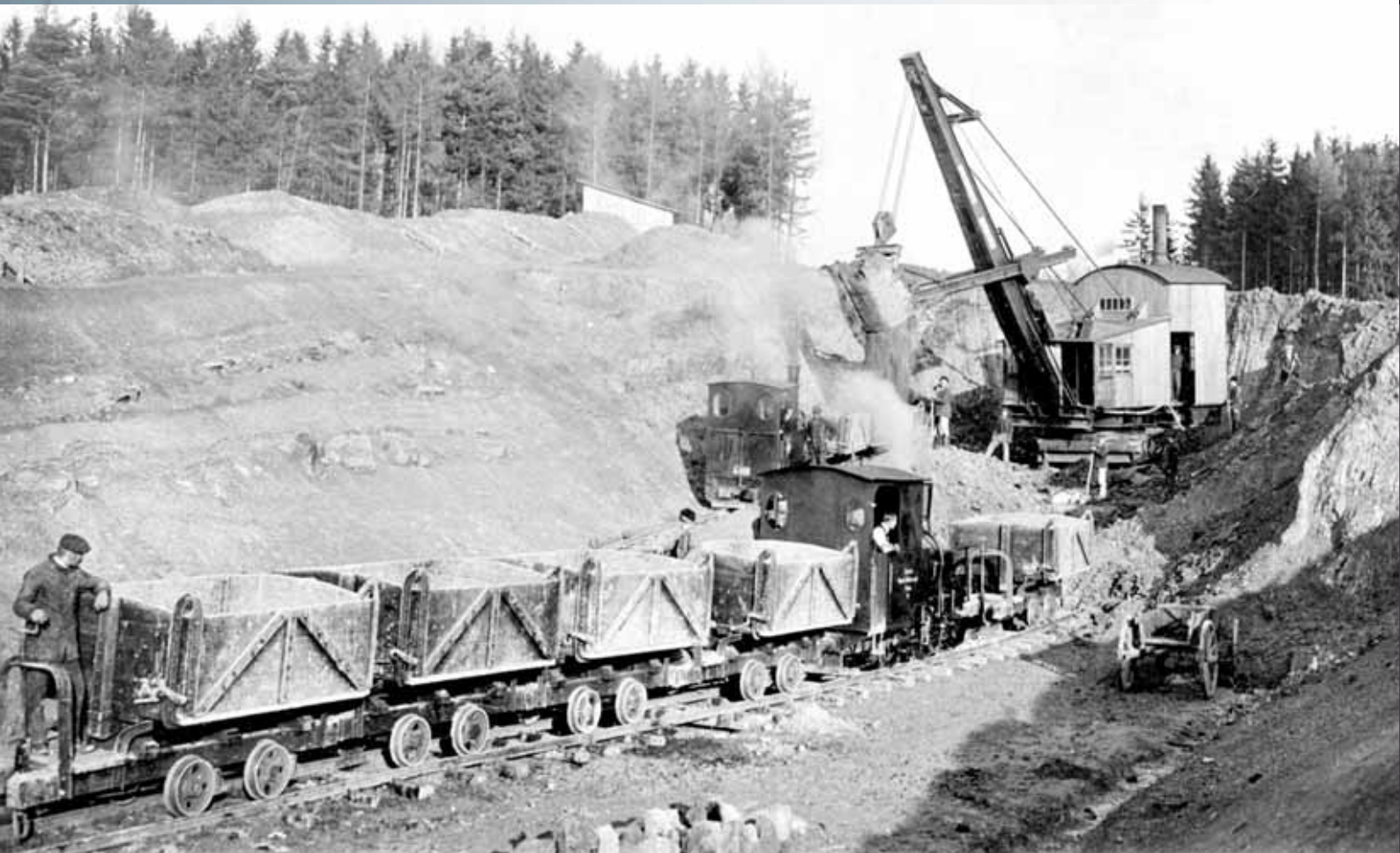
Stavby dráhy Veselí nad Moravou–Nové Město nad Váhom se v úseku u Myjavy od roku 1924 účastnila i pražská firma Nejedlý, Řehák a spol. Její rypadlo Škoda s lopatou 2 m 3 však bylo zdrojem potíží a část prací firma nedokončila.
