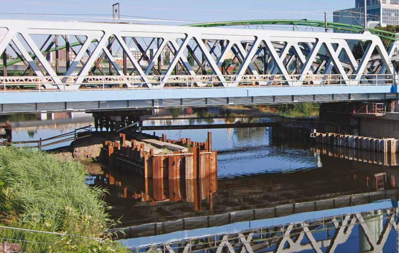
Most v Kolíně po uložení nové návodní poloviny konstrukce; zleva: pomocná jímka s pířmo bářkou, pilíř P2, pilíř P3 a opěra O2
