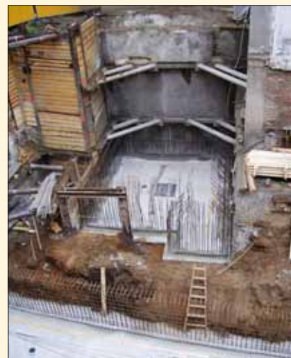
Pohled z ulice Benediktské na stavební jámu v místě rozšíření o podzemní garáže v sousedním objektu
