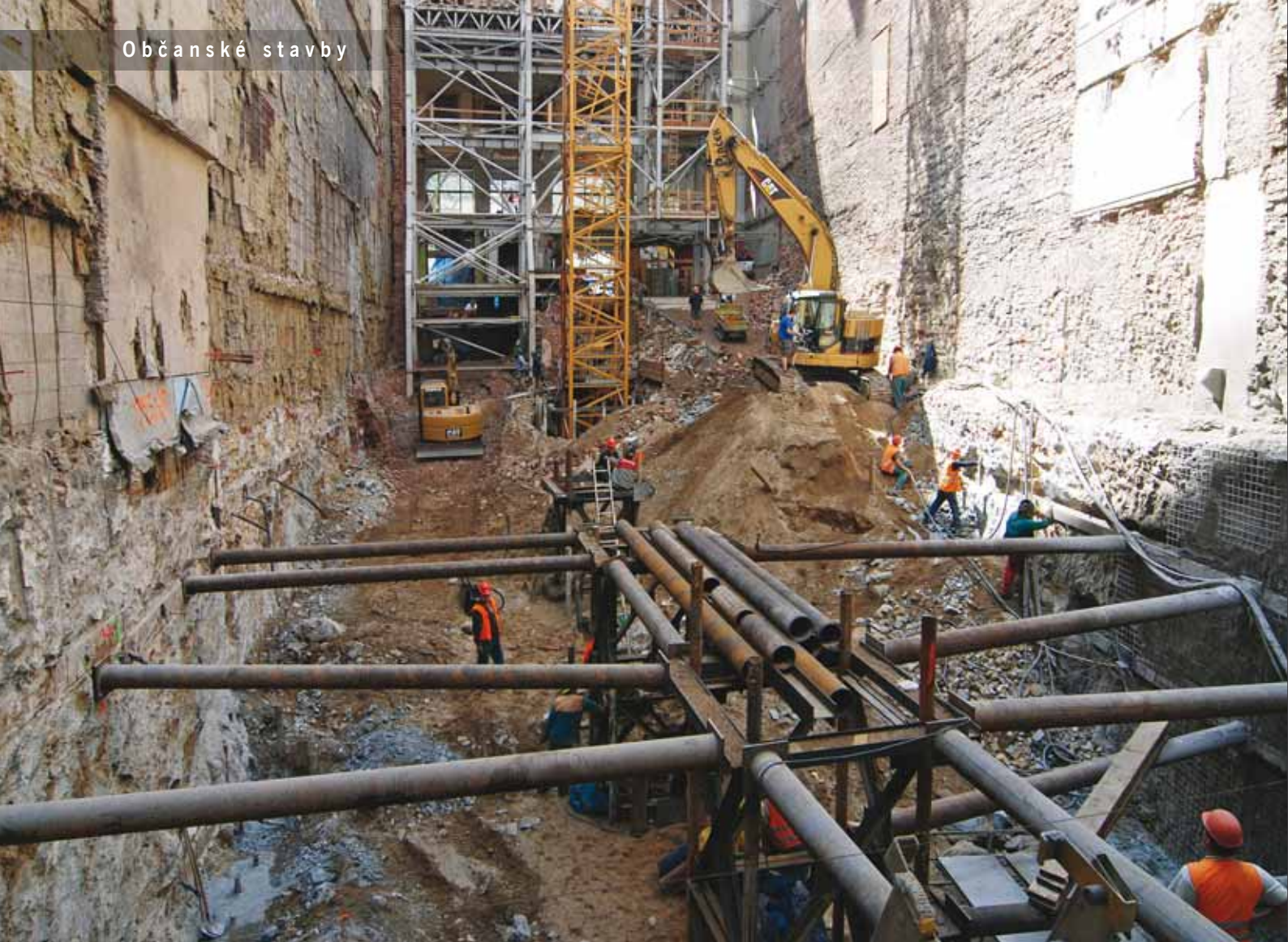
Pohled na stavební jámu směrem k fasádě do Václavského náměstí, v popředí je budována ocelová rozpěrná konstrukce
