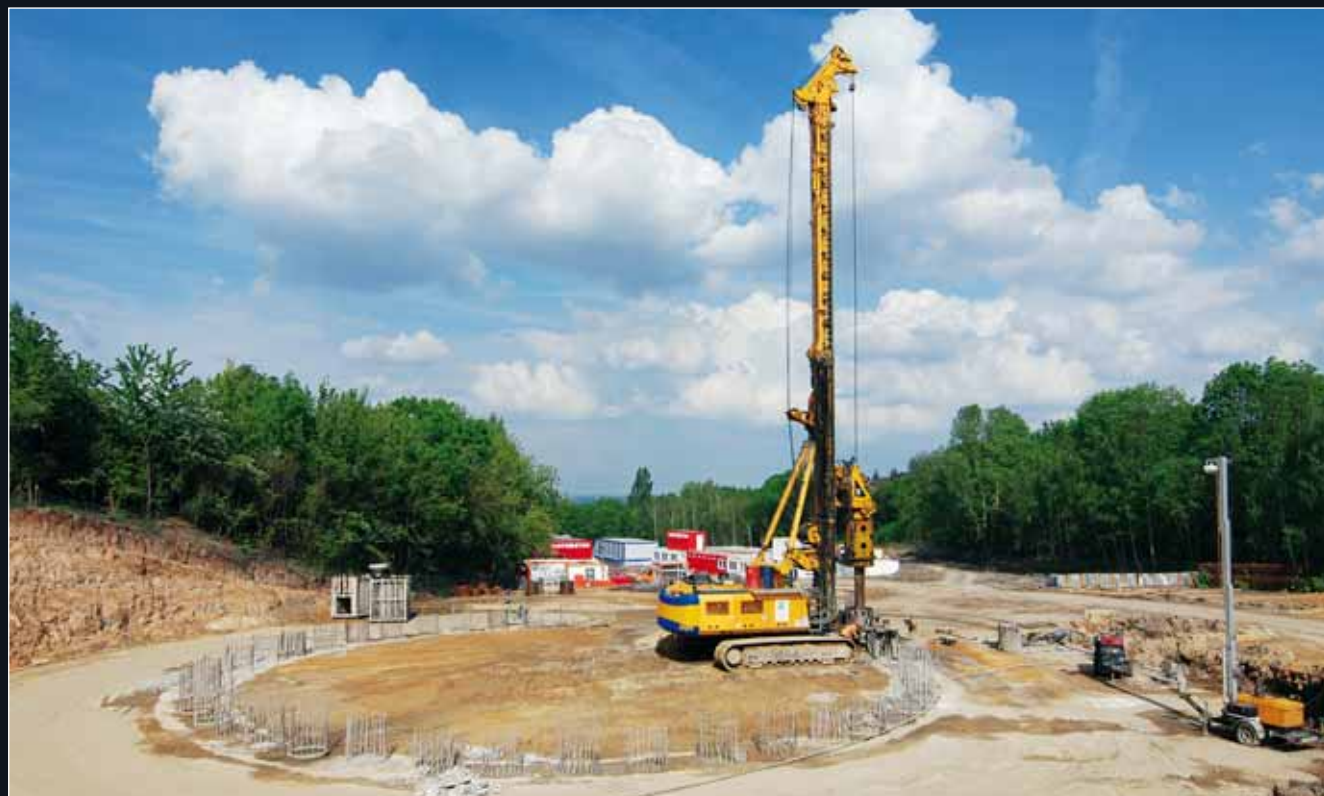
↑ Provádění jedné z celkového počtu 88 ks pilot, které tvoří plášť montážní štol ← Montážní šachta na staveništi BRE 1 v blízkosti křižovatky Vypich mezi stanicemi Motol a Petřiny budované trasy metra V. A bude sloužit především pro montáž razicích štítů technologie TBM EPB.
