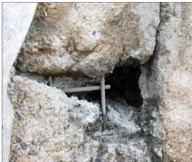
Obr. 2: Ukázka okrytého a očištěného hnízda bentonitu v zámku podzemní stěny, před sanací (archiv autora)
