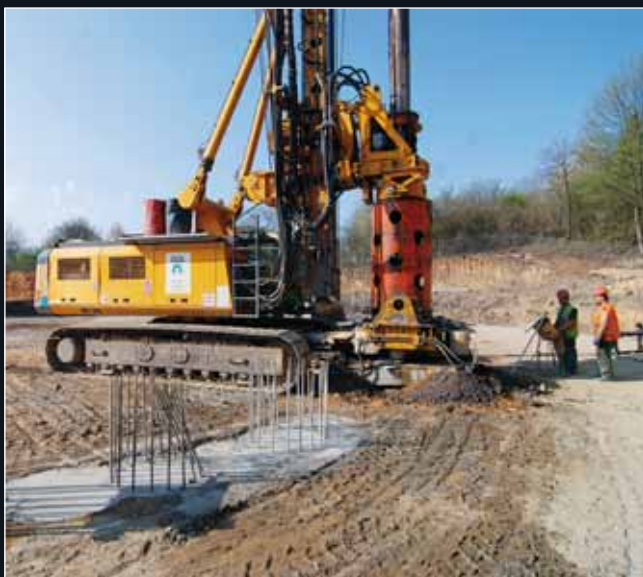
Vrtná souprava Bauer BG 25 s dopažovací mřížkou Leffer při provádění převrtávaných pilot
