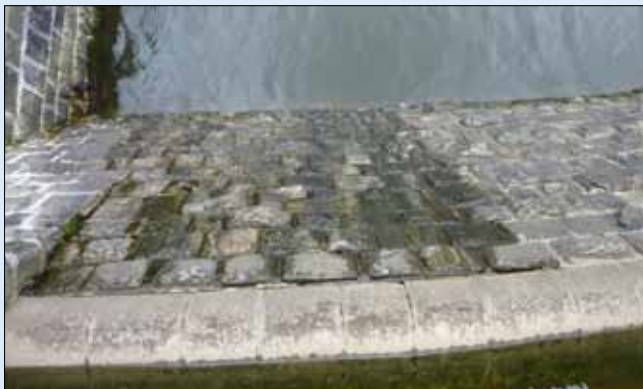
Průsaky v levém přelivném poli před injektáží, pohled na vzdušný líc
