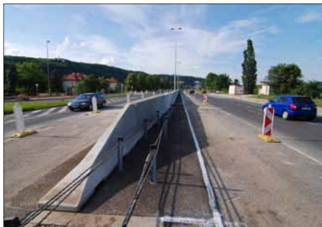
Křížení lanových a prefabrikovaných svodidel tvořící náběh na protipovodňovou stěnu (OP 203)
