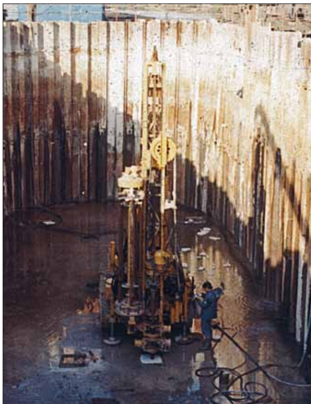
Obr. 10: První vrtání ponorným kladivem většího průměru v ČR v roce 1978 na stavbě Barrandovského mostu. Pro vrtý mikropilot o průměru 360 mm a délek 10 až 14 m bylo v tvrdých vápencích podzákladí použito kladivo Stenuick a kompresor Hollman (Závod SZS, Vodní stavby, o. p.).
