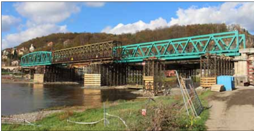
Výsuv nové nosné konstrukce v hlavním poli, původní mostní konstrukce je využita jako výsuvný nosník
