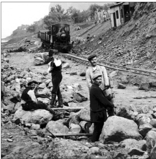
Obr. 2: Rozrušování balvanů pomocí archaické techniky sochoru a palice na stavbě Masarykova zdymadla pod Střekovem v roce 1923 (Z. Bauer, Stavební stroje firmy Lanna, str. 88)
