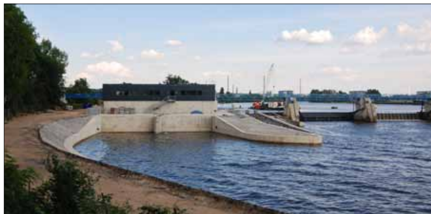
Dokončená MVE Štětí během zkušebního provozu
