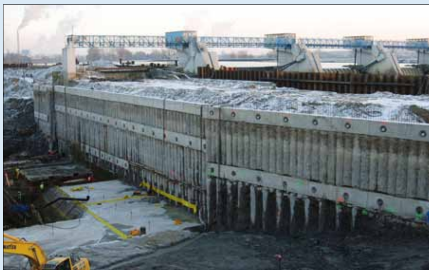
Stavební jáma v místě jezového pilíře zajištěná kotvenou převrtávanou pilotovou stěnou, hloubka výkopu pro jámu dosahovala až 18 m od původního terénu.
