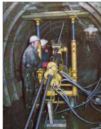
Obr. 15: Vrtání plně hydraulickou vysokootáčivou jádrovací soupravou Diamec 250 pro sanaci nadloží před ražbou traťového tunelu metra I. a pod Vltavou v roce 1973 (o. z. SZS Vodní stavby o. p.)
