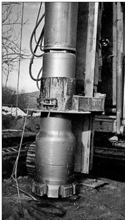
Obr. 5: Vrtání pilot o průměru 900 mm ponorným kladivem Sandvik XL24 na soupravě Soilmec R12 a s třemi kompresory Atlas-Copco v amfibolitech s křemennými žilami na stavbě Omya Vápenná v roce 1997 (Zakládání staveb, a. s.)
