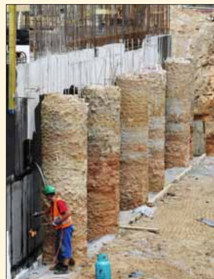
Obnažené piloty, důsledek rozdílných základových spár sousedních stavebních objektů
