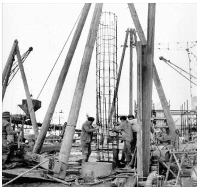
Obr. 3: Stavba s vrtáním pilot několika soupravami trojnožek klasickým nárazovým způsobem pomocí lanového vrátku, jímž byly také osazovány armokoše, Bone Centrale, Francie, rok 1950 (firma Soletanche)
