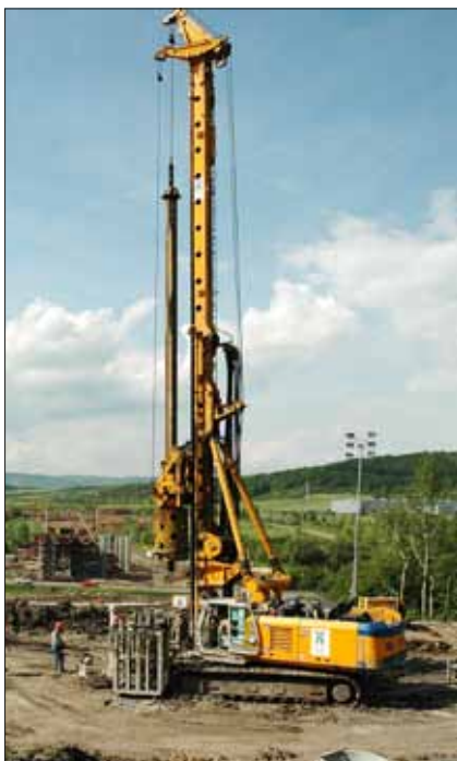
Obr. 12: Pilotovací souprava Bauer BG 25 s lafetou nesenou paralelogramem a s posuvnou vrtnou hlavou, zavrtávající výpažnici v roce 2003 (Zakládání staveb, a. s.)
