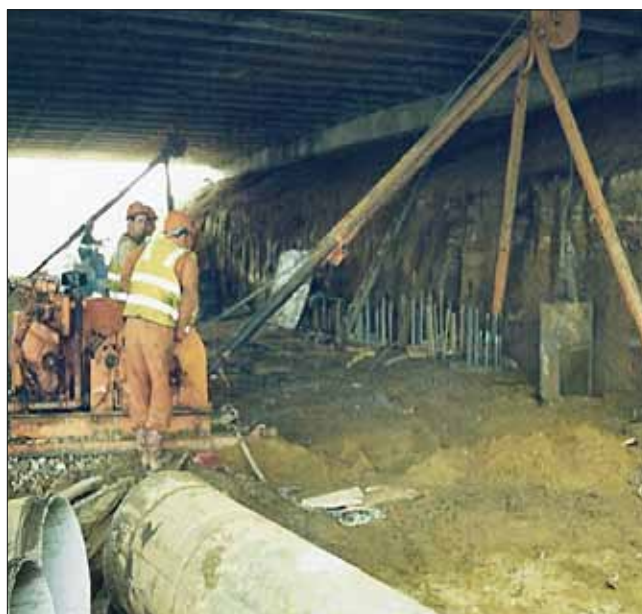
Obr. 4: Provádění pilot ve stísněných podmínkách s vrtáním pomocí nízké trojnožky. Přestavba existujícího dálničního mostu, Velká Británie, rok 1991 (firma Stent Foundation).
