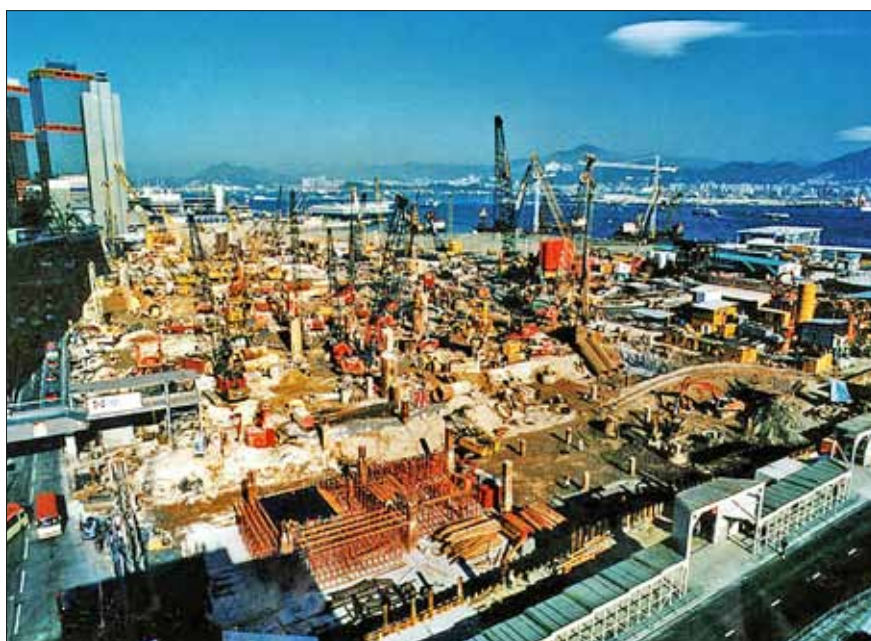
Obr. 1: Ukázka staveniště s velkým podílem pilotovacích souprav mezi mechanismy různých technologií, stanice metra Central Station Hongkong v roce 1996 (firma Soletanche)
