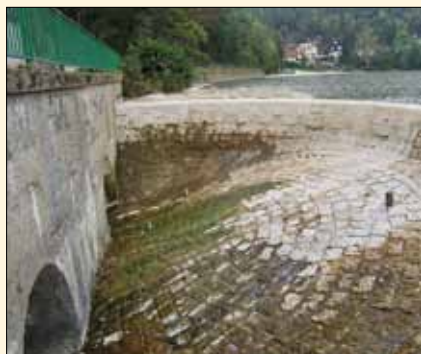
Průsaky vody zdířem kašnového přelivu
