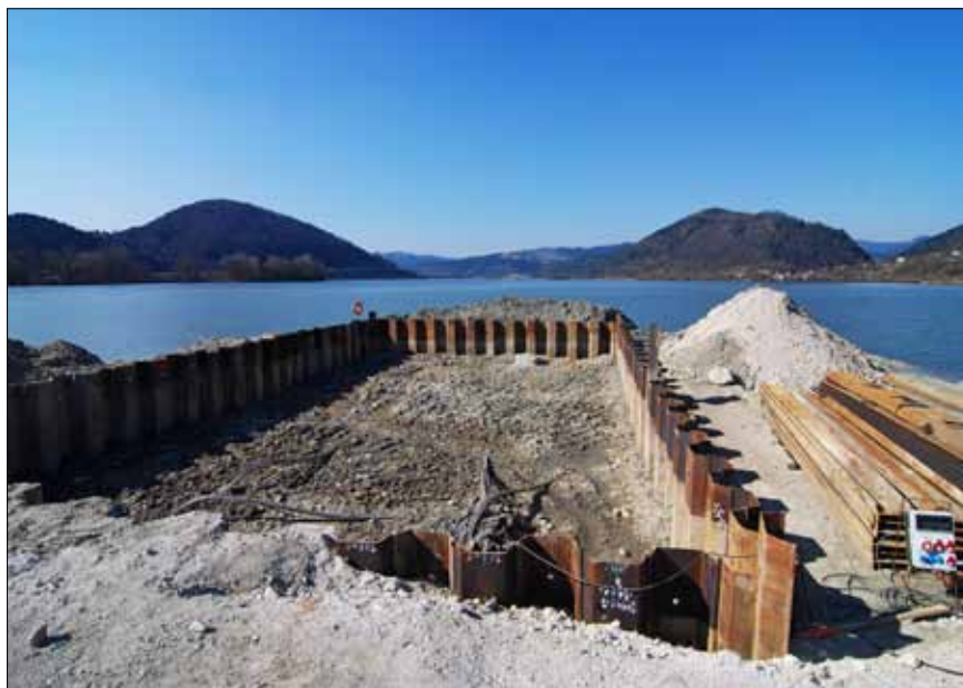
Rozsáhlá štětová jámka pro ochranu pilotového založení podpěr na úseku TC3, stav před odkopáním hlav pilot
