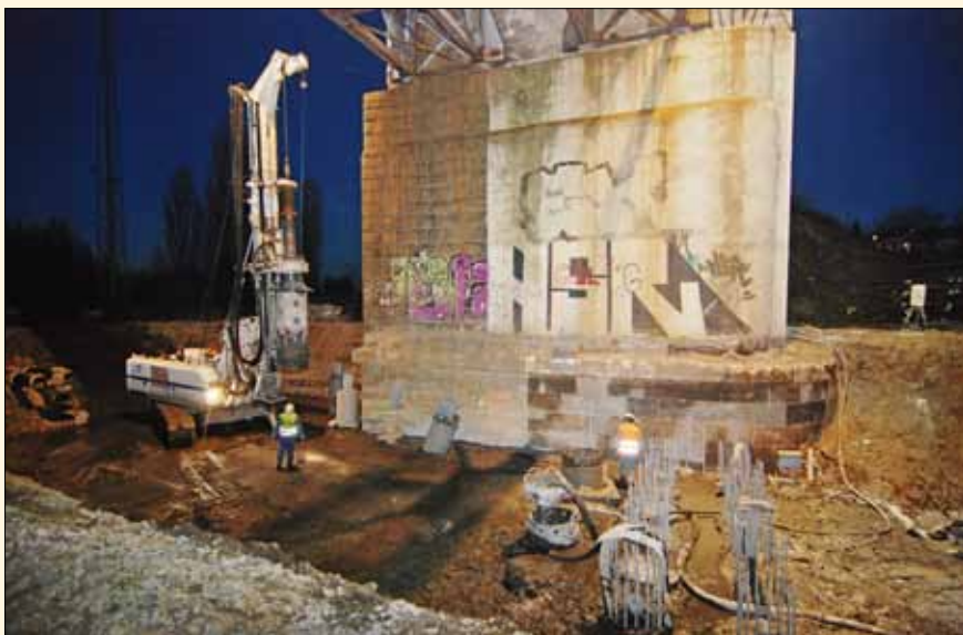
Realizace hlubinného založení na opěře OP1 přímo pod mostní konstrukcí vrtnou soupravou SOILMEC R 320
