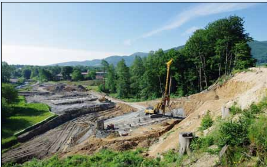
Obr. 16: Zakládání mostu SO 210 přes vodoteč (km 9,324) na skupině pilot v úseku Nebory–Oldřichovice
