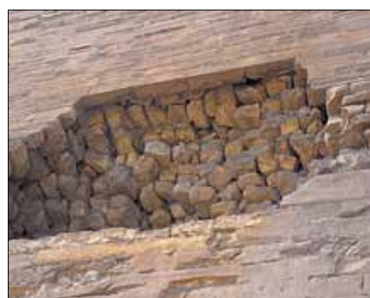
Obr. 2: Pyramida Médúm v Egyptě z období 2750 let př. n. l. s poruchou líce obnažující pohled na vnitřní stavbu z kamenné rovnání (internet)
