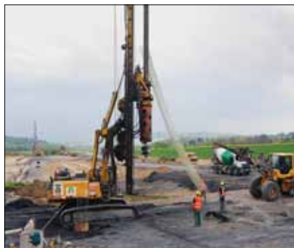
Osazování sklolaminátové výztuže do piloty portálové stěny před ražbou Ejpvovických tunelů, Zakládání staveb, a. s.
