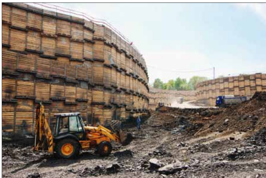
Obr. 4: Výhodné použití kotveného záporového pažení v členité geometrii portálové jámy hloubeného tunelu Blanka na Letné v roce 2008; hloubka v zachyceném místě cca 22m (Zakládání staveb, a. s.)
