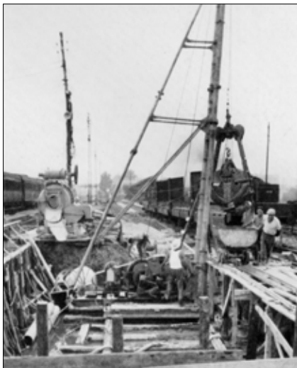
Obr. 5: Původní model lehkého dvoulanového drapáku na trojnožce na stavbě firmy I.C.O.S. pro podchod na benátském nádraží Mestre v Itálii v roce 1963 – je zřejmá obtížná ruční manipulace při vyprazdňování drapáku do vozíku (firma I.C.O.S.)
