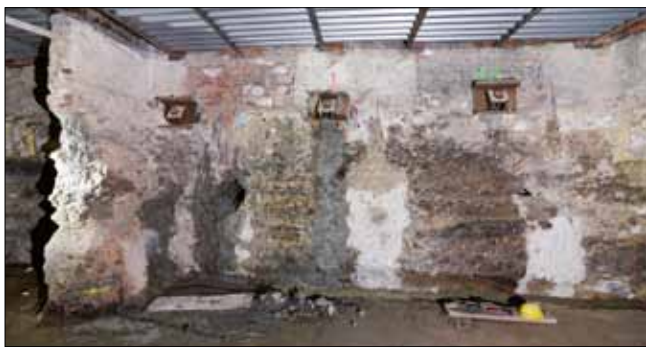
Suterénní zdivo posílené sloupy tryskové injektáže; sloupy T1 jsou zde navíc využity pro pažení výkopu nového suterénu.
