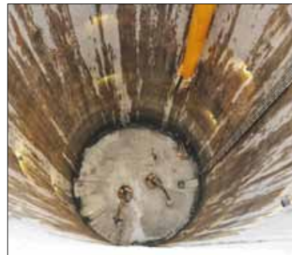
Obr. 14: Výkop v šachtové nádrži Abbey Mill zhotovené z podzemních stěn, jedné z několika takových akumulčních nádrží příválových vod nového londýnského stokového systému budovaného v roce 2011 (Bachy-Soletanche)
