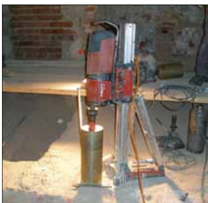
Provádění jádrového vrtu z 2. NP do středu sloupů SL1 a SL2 pro uložení ocelové trubky
