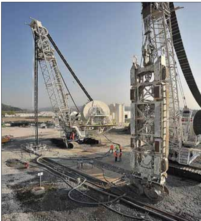
Obr. 15: Dvě soupravy hydrofréz nového typu Tiger SC-135 (vpravo) a SC-200 italské firmy Soilmec při zhotovení zkušební podzemní stěny hloubky 250 m v roce 2012 (Soilmec)
