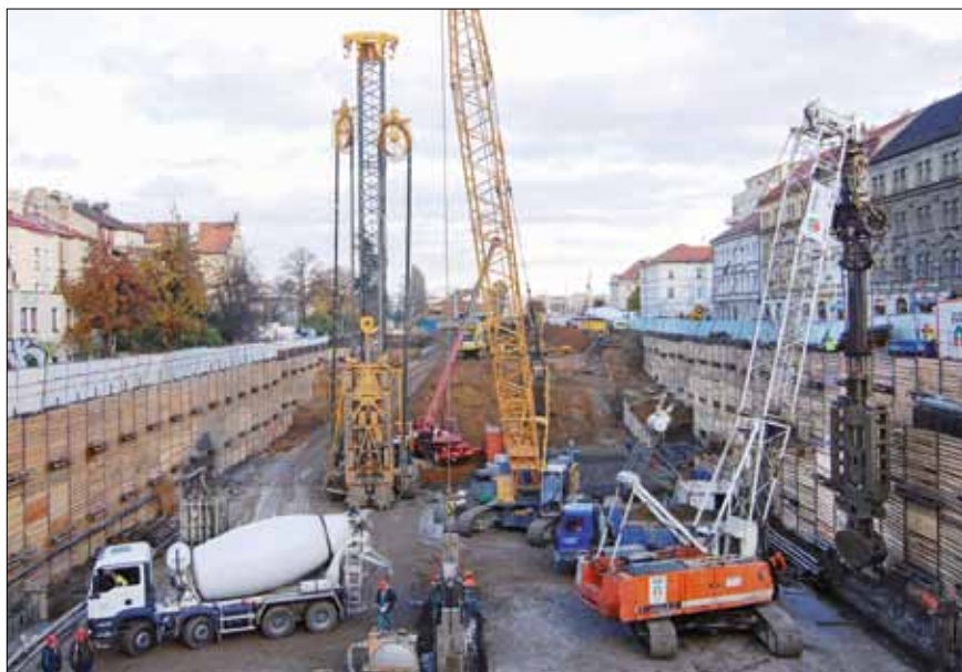
Obr. 1: Charakteristická realizace podzemních stěn pomocí drapáku a hydrofrézy z předvýkopu v kotveném záporovém pažení na stavbě Tunelu Blanka, 2009, (Zakládání staveb, a. s.)
