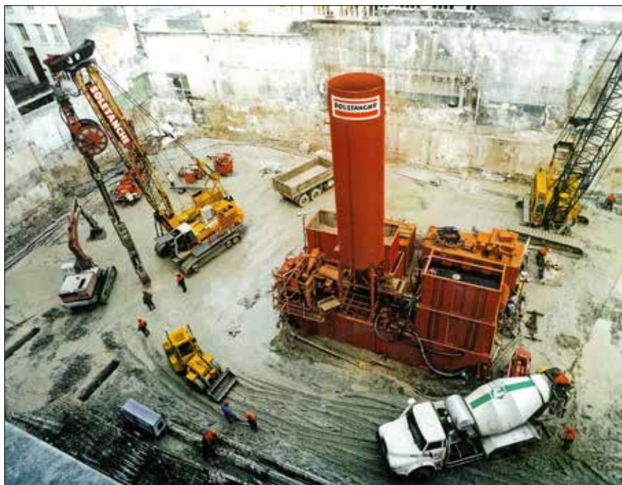
Obr. 6: Pohled na pracoviště podzemních stěn s kompaktní výrobou a čističkou pažicí bentonitové suspenze na stavbě ve Francii v roce 1991. Jsou zachyceny všechny další části technologie od hybridního drapáku a odklizení výkopku přes přípravu stopendů a armatury až k betonáži s těžkým servisním bagrjeřábem (Soletanche).
