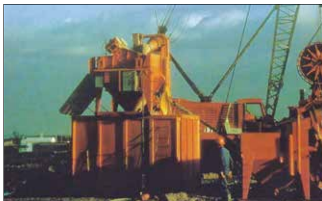
Obr. 5: Kompaktní čistička bentonitové suspenze Caviem s hrubým a jemným vibrosítem a s velkým hydrocyklónem na stavbě podzemních stěn s drapákovou těžbou na začátku 80. let (Caviem)
