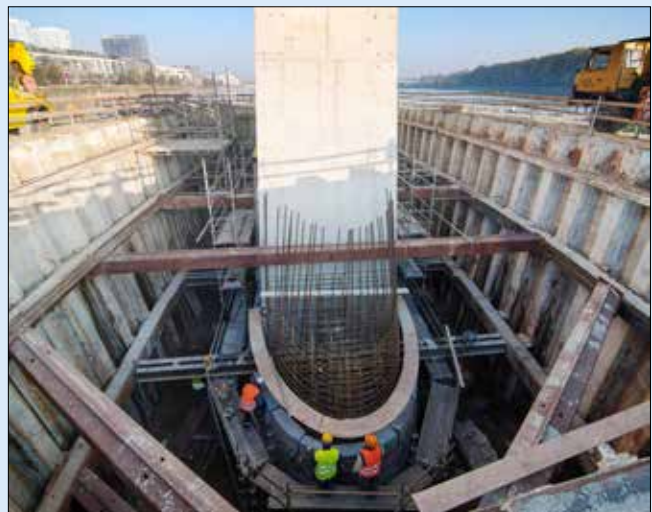
Jímka pro pilíř 34 s již dokončenými hlavními sloupy, příprava na betonáž spodní rozšířené části pilíře přímo do žulového obkladu (11/2015)
