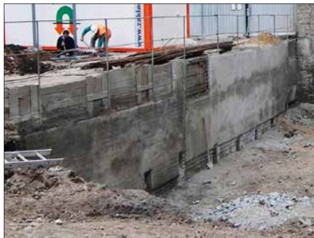
Obr. 10: Těsnicí podzemní stěna jílostrusková s vloženými I-profilů, stavba bytového domu na Petřském náměstí v Praze, rok 2009 (Zakládání staveb, a. s.)
