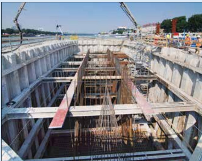
Jímka pro pilíř 34 rozepřená ve třech úrovních během výstavby dvou hlavních železobetonových dráků pilíře (8/2015)
