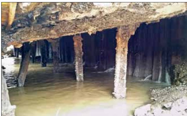
Pohled do nitra jezu s vymletou kavernou, zajímavostí je velmi dobrý stav návodní dřevěné štětovnicové stěny. (Foto vlevo: J. Šimůnek, foto vpravo: autor)
