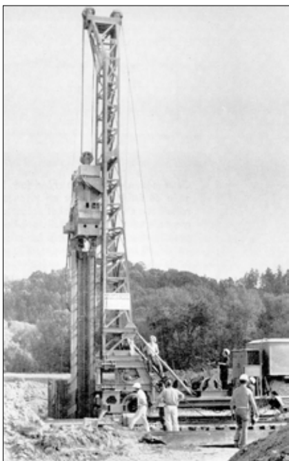
Obr. 8: Jedno z prvních nasazení těžkého elektrovibrátoru na lafetě ještě s kolejovým podvozkem pro zhotovení tenkých těsnicích stěn na stavbě hornodunajské elektrárny v bavorském Bittenbrunnu v roce 1966 (Soletanche).
