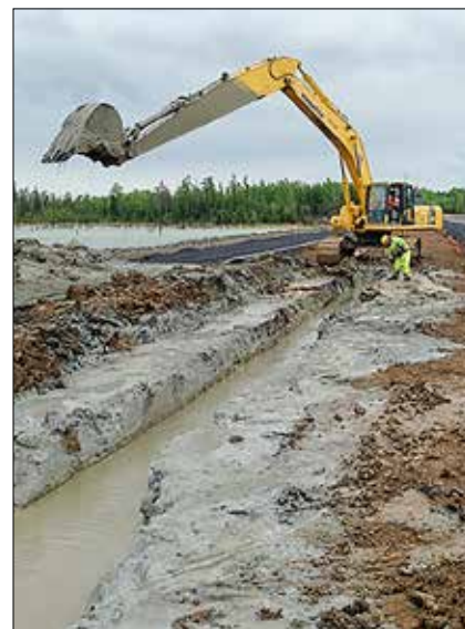
Obr. 3: Typický způsob provádění těsnící clony ze samotvrdnoucí suspenze s užitím konvenčního rypadla s podkopovou lžící na dlouhém výložníku na počátku 20. století (internet)
