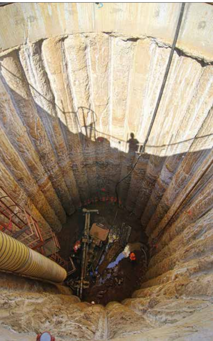
Pohled do vytěžené šachty během rozrážky přístupové štoly k tunelové propojce č. 6
