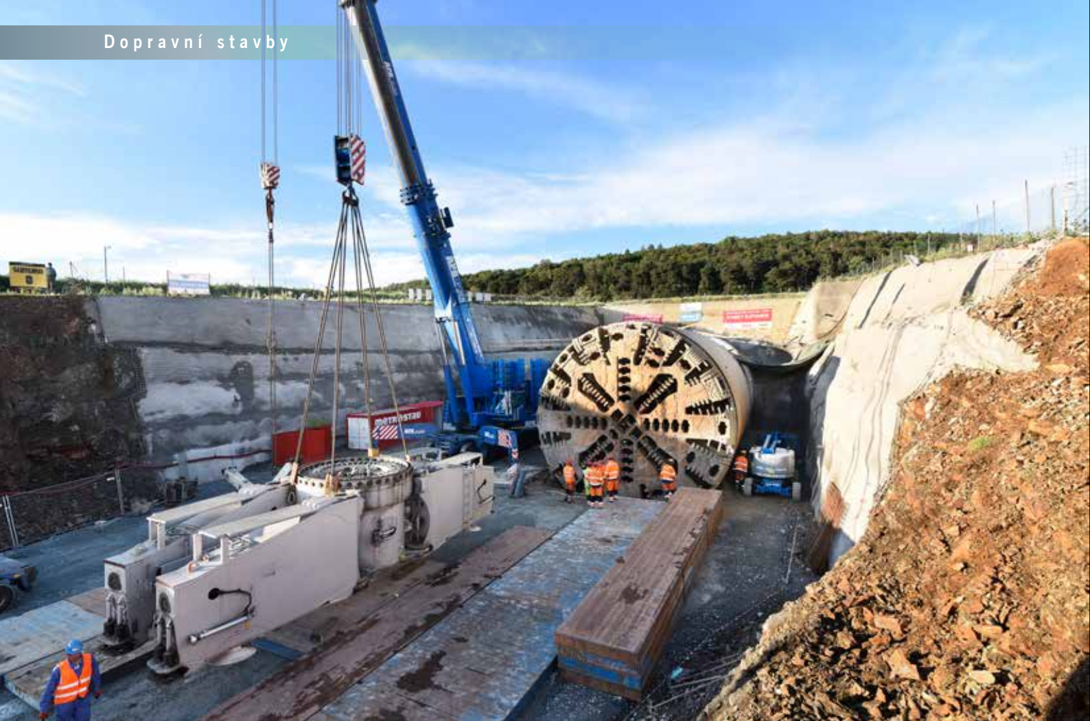
Výjezdový portál Chlum s razícím štítem TBM krátce po dokončení ražeb jižní tunelové trouby
