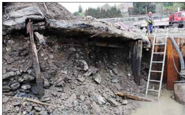
Konstrukce jezu před odstraněním jeho tělesa, dobře jsou vidět obě dřevěné stěny, kolejnice a návodní kamenná rovnánina, původně tvořící předprsí jezu.
