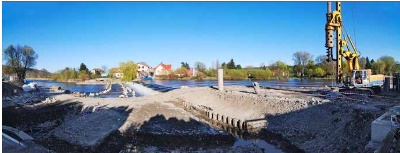
Pohled z levého břehu na počáteční fázi vrtání návodní pilotové stěny jezové konstrukce.
