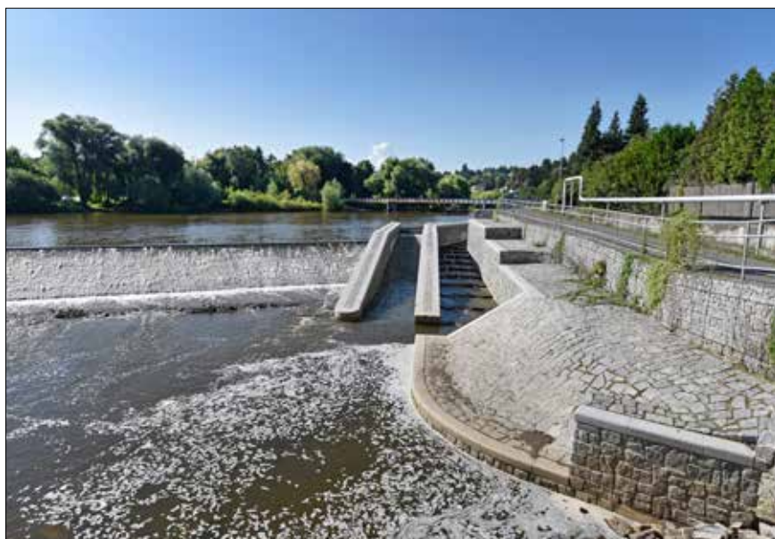
Dokončená levobřežní část jezu s lodní propustí a rybím přechodem, stav ještě před odstraněním provizorních jímek pro pravobřežní část jezu, takže voda v podjezí je vzdutá o cca 50 cm.
