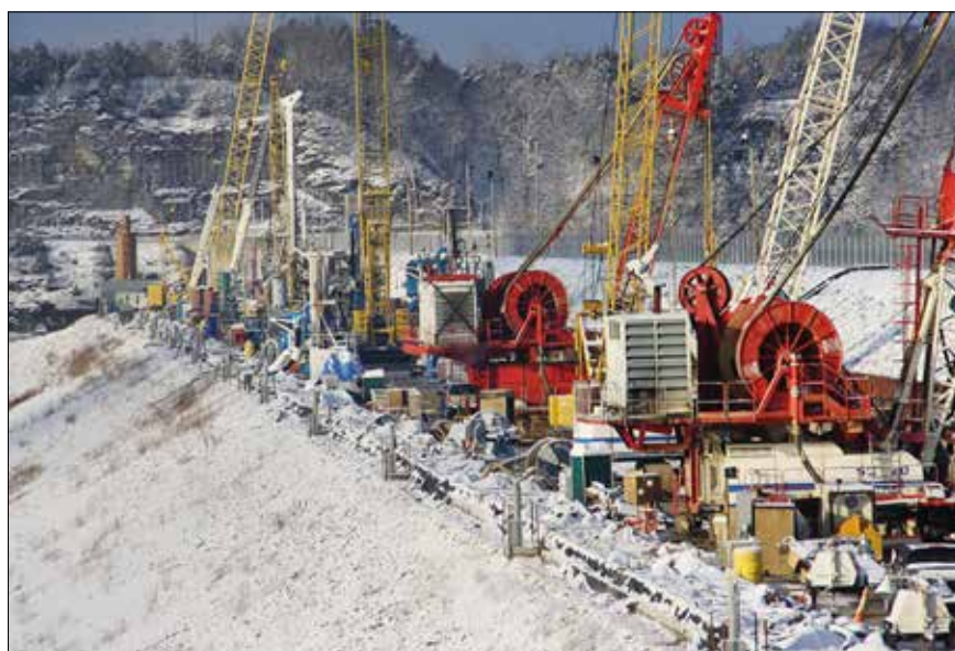
Obr. 6: Havarijní rekonstrukce těsnicí clony zemní přehradě Wolf Creek na řece Cumberland v Kentucky v USA v roce 2014. Nově byla k odstranění průsáku krasovým podložím zřízena betonová podzemní stěna do hloubky 90 m. Na koruně hráze byla při provádění skutečná skrumáž speciálních těžkých mechanismů (Trevi/Soletanche).
