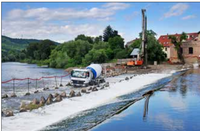
Pro obsluhu prací spec. zakládání těžkou technikou na pravé straně řeky bylo nutno přes celou šířku toku zřídit brod.
