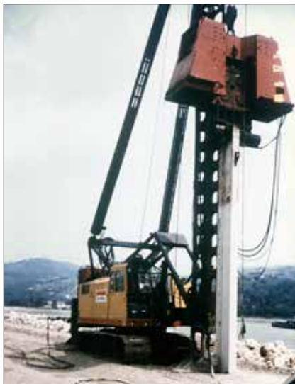
Obr. 9: Budování tenké těsnicí clony do hloubky 10 m pro hráz později zrušeného projektu přehrady Nagymaros na řece Dunaj v Maďarsku v roce 1988. Rakouská firma UniversalBau použila ve štěrkopiscích těžký elektrovibrátor Ferrokonstrukt 40 t na hydraulickém nosiči Ackerman (autor)
