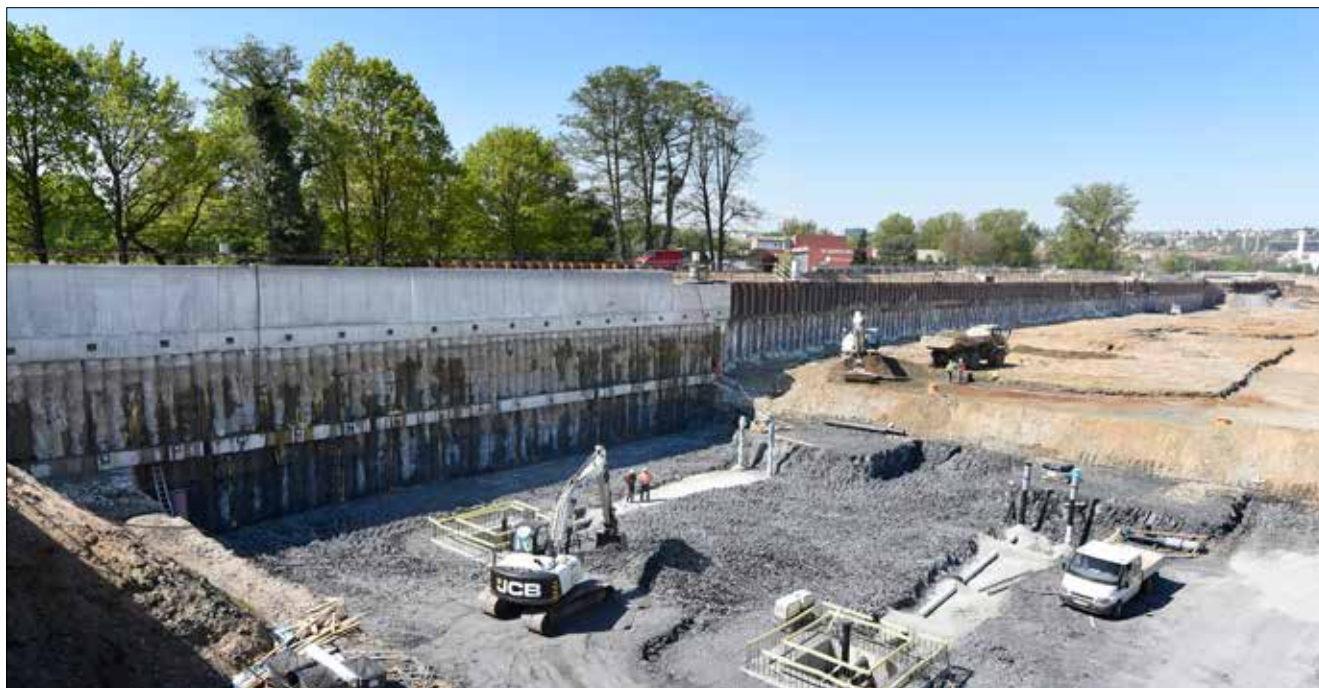
Jihovýchodní roh stavební jámy zajištěný kotvenou převrtanou pilotovou stěnou s navazující štětovou stěnou
