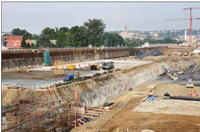
Východní část stavební jámy během výstavby objektů biologického čištění a třetího stupně čištění (SO 09)
