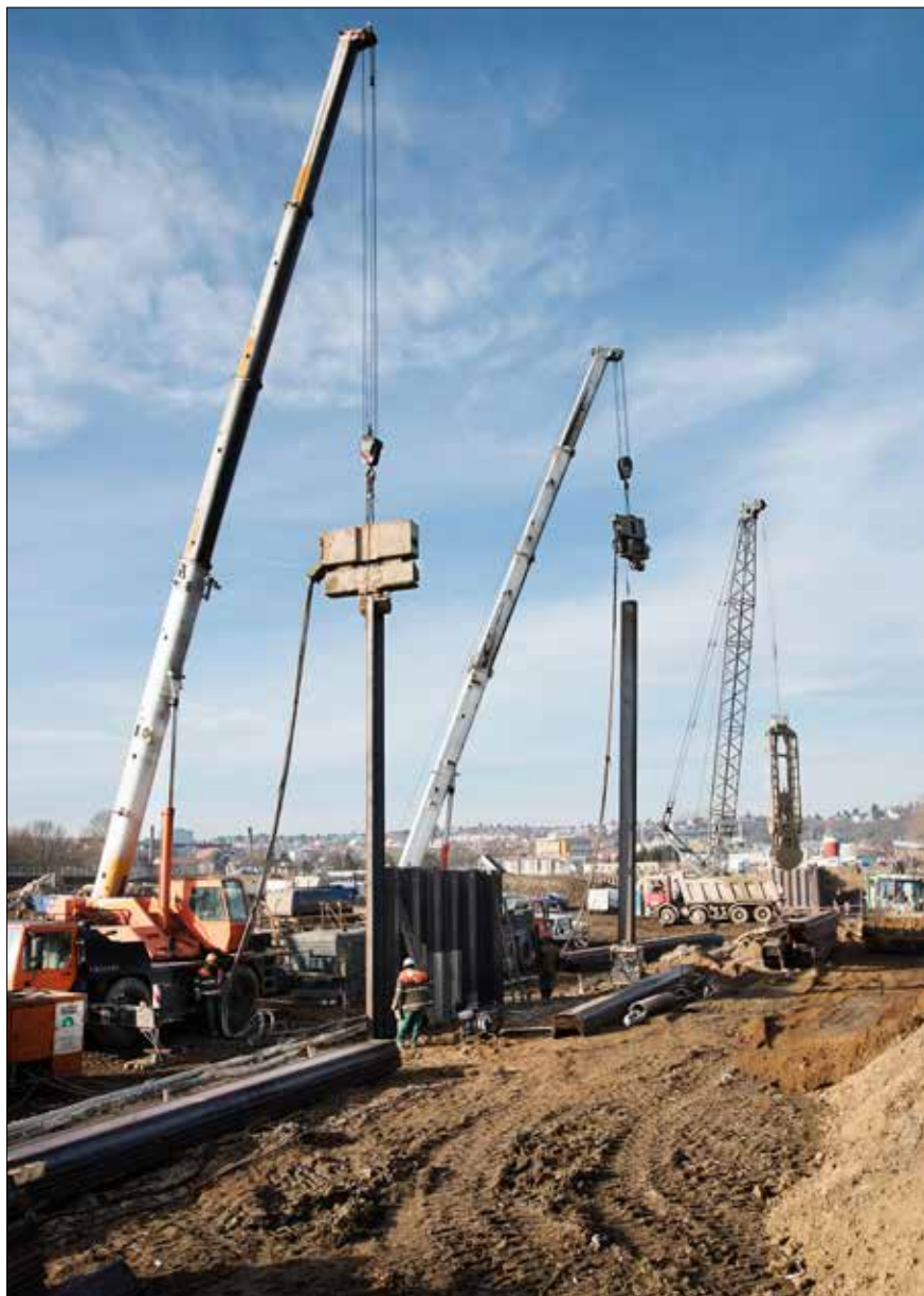
Těžba rýhy podzemní stěny a následné beranění štětových stěn, severní strana stavební jámy
