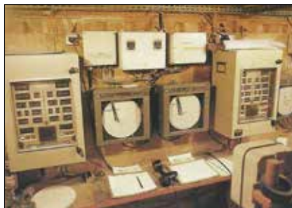
Obr. 13: Společná elektronická a mechanická instrumentace a monitoring injektáží na stavbě vídeňského metra v 80. letech 20. stol. (Soletanche)
