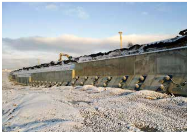
Pohled na hotovou zárubní zeď objektu SO 281-48 po osazení krytů hlav kotev
