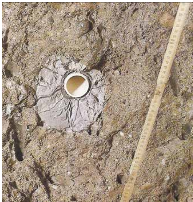
Obr. 3: Kolmý odřez proinjektované základové půdy s osazenou manžetovou trubicí se zřetelným paprskovitým protrháním plastické zálivky tlakem prostupující jílocementové injekční směsí předvedený v roce 1970 (Soletanche)
