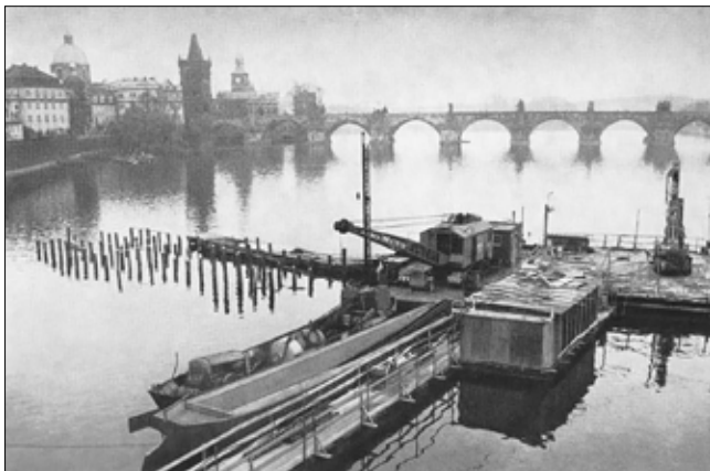
Obr. 6: Injektáž nadloží tunelů metra v řečišti Vltavy na trase A v roce 1975 (Zakládání staveb)
