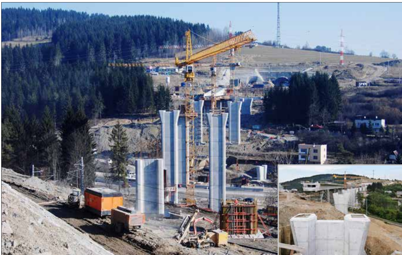
Pohled v ose budoucí dálnice směrem k tunelu Svrčinovec, (březen a srpen 2015)
