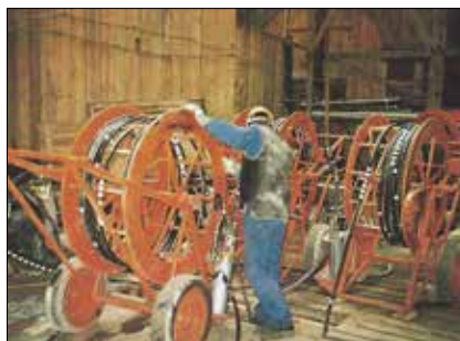
Obr. 14: Cívkové vozíky injekčních hadic s hydraulicky rozpínanými obturátory na injekčním poli stavby vídeňského metra v 80. letech 20. stol. (Soletanche)
