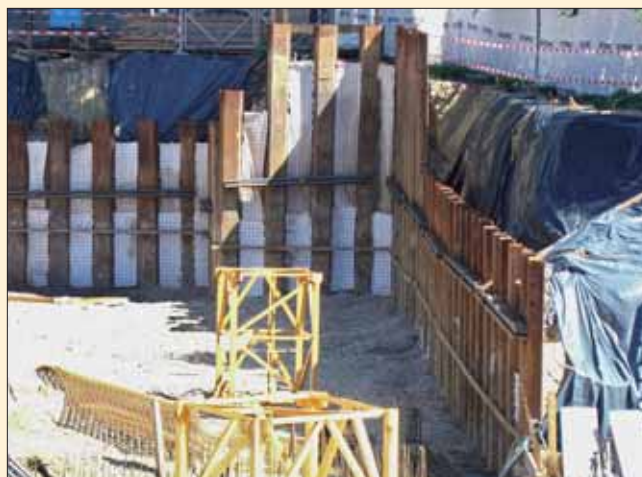
Lokální zvýšení beraněných štětovic v místě umístění veřejného osvětlení
