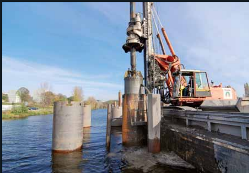
Práce na vodě byly náročné na provádění mj. i proto, že piloty bylo nutno zhotovit s maximální půdorysnou odchylkou \pm 50 mm
