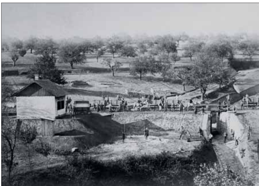
Při stavbě dráhy ze Střelic u Brna do Hrušovan nad Jevišovkou v letech 1866–1870 sice používal stavitel Martony železniční vozíky pro odvážení zeminy, k jejich posunu však sloužili koně.
