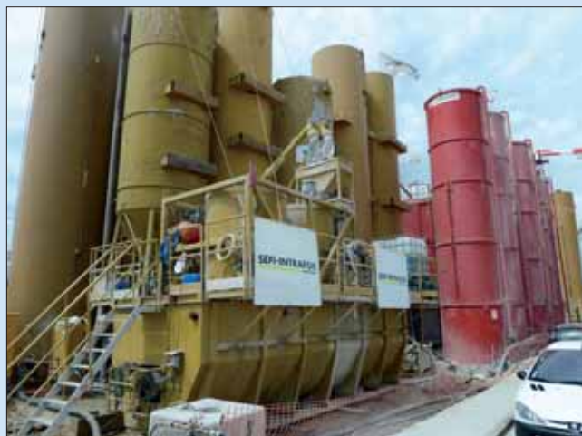
Míchací stanice a čistička pažicí suspenze
