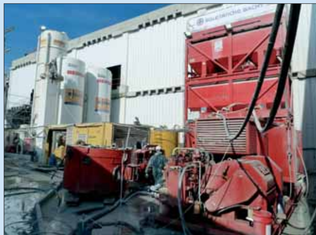
Strojní zařízení pro výrobu injekční směsi včetně vysokotlakých čerpadel
