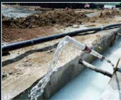
Artéská voda vytékající nad úrovní terénu ze zasnované lamely podzemní stěny
