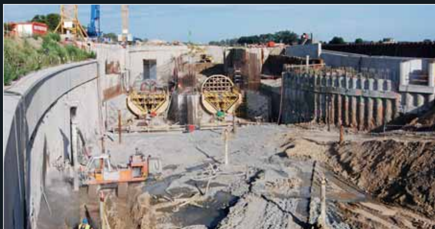
Stavební jáma během betonáže konstrukcí elektrárny; v popředí jsou zachyceny odlehčovací vrty, vlevo probíhá tréžování povrchu PS.
