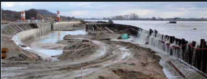
Přepad vody přes dolní štětovnou jámku během povodně v lednu 2011
