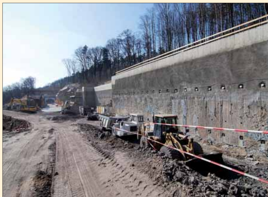
Trvale kotvená podzemní stěna, pohled směrem k portálu raženého tunelu obrátových kolejí přes jejich hloubený úsek
