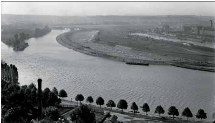
Pohled z Bílé skály v září 1924 na stavenišťe „Maniny“: výkop nového řečiště Vltavy je přibližně uprostřed obrázku, vlevo od něj původní řečiště s vjezdem do libeňského přístavu na kraji, napravo je bazén holešovického přístavu. Libeňský most se ještě nezačal stavět, místo něj fungoval provizorní dřevěný most.
