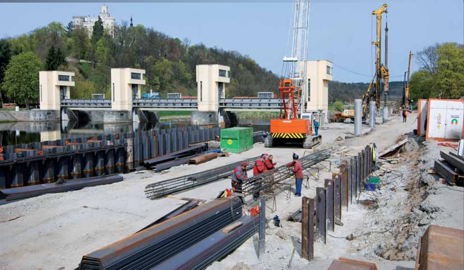
Pohled na jez a zámek Hluboká přes staveniště před zahájením výkopu stavební jámy
