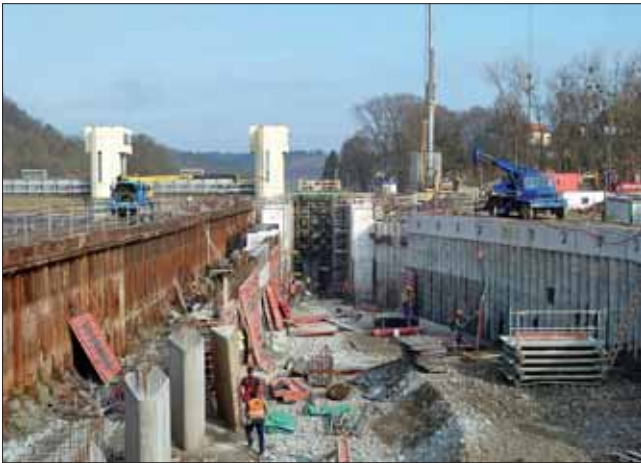
Horní rejsa při úpravě líce pilotové stěny a betonáži dělicí zdi ze suché stavební jámy
