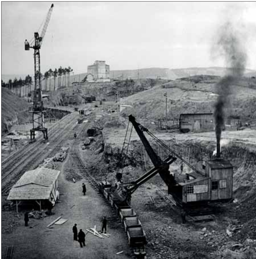
V roce 1941 už probíhal i výkop horní nádrže budoucí přečerpávací elektrárny na kopci Homole nad Štěchovickou přehradou.
