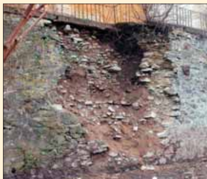
Zřícená část hlavní opěrné zdi
