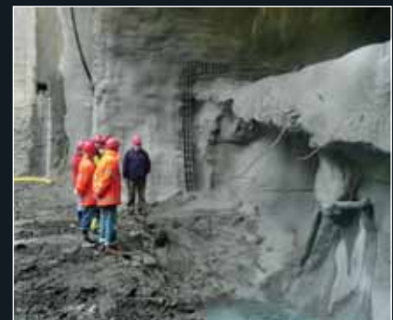
Sanovaná část nestabilní čelby spodní části výrubu I. etapy ražby – následně byly doplněny „zámkové“ vrty v této spodní oblasti ve všech dalších etapách
