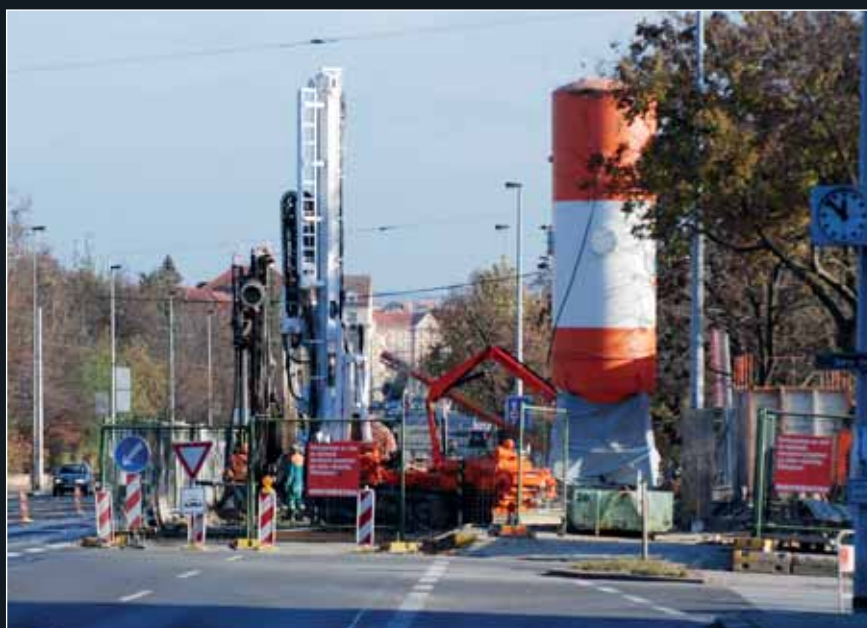
Provádění svislé těsnící stěny z tryskové injektáže z prostoru vozovky Evropské ul. (1. etapa záboru)
