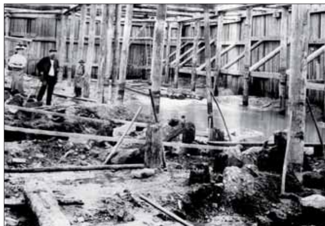
Jímka II. etapy vytěžená na základovou spáru se zbytky starého roudnického mostu
