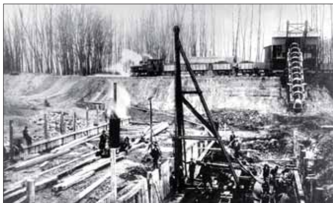
Beranění jímky I. etapy na pravém břehu parním nárazovým beranidlem, v pozadí parní korečkové rypadlo
