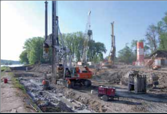
Práce na zhotovení obvodových převrtávaných pilotových stěn a štětové stěny na výtoku
