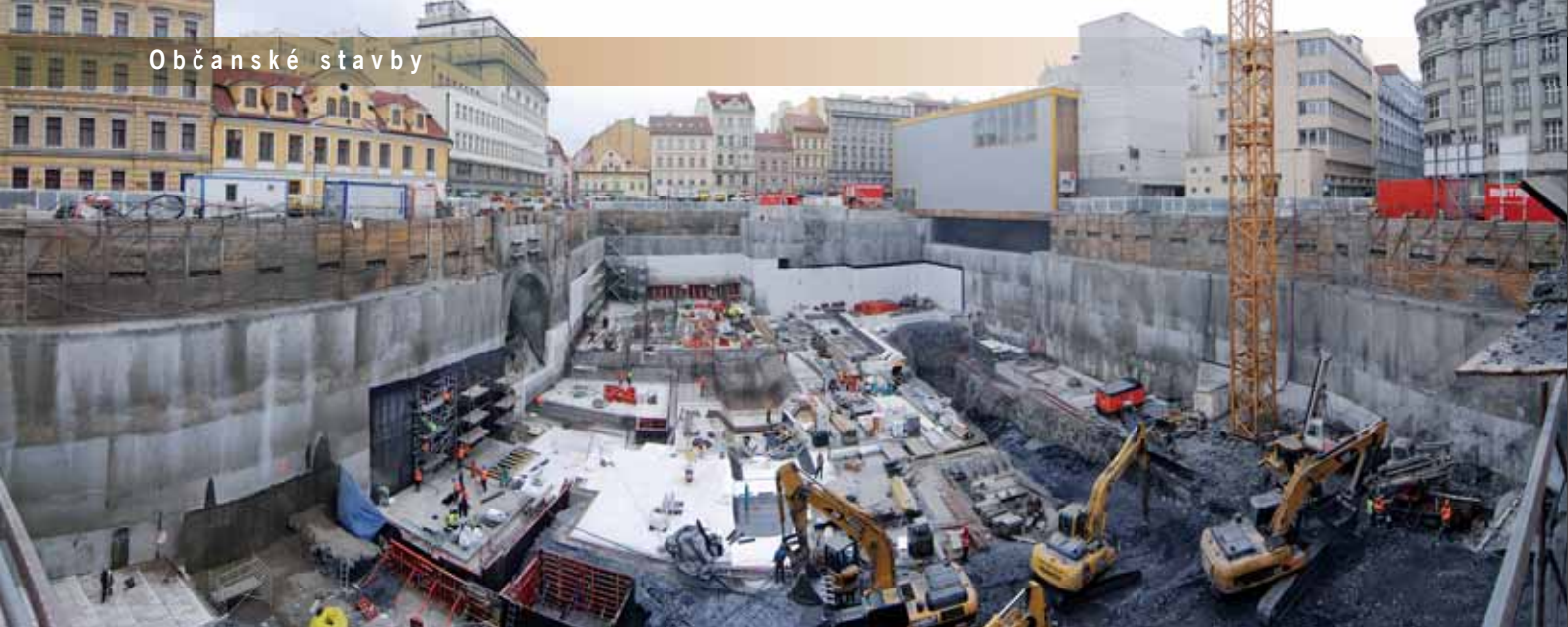
Souběh různých stavebních činností na staveništi, vpravo hloubení a zajišťování VZT kanálu
