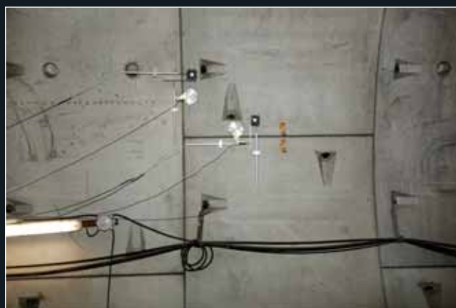
Obr. 4: Automatické deformetry na spárách mezi segmenty (sdružení ARCADIS – INSET)
