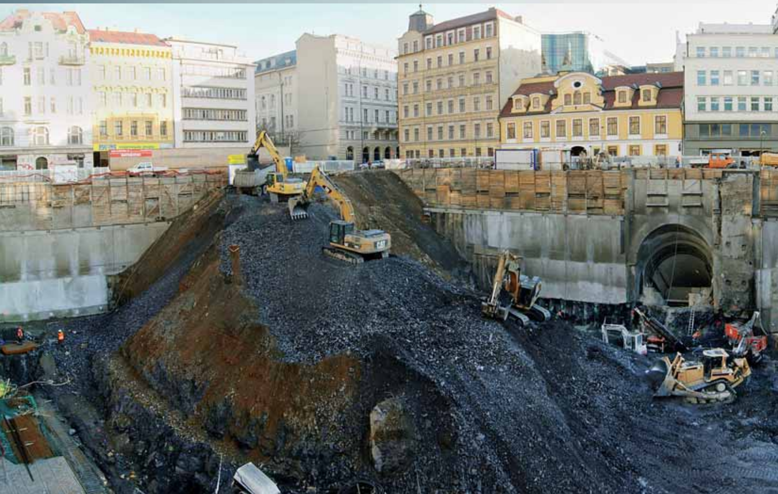
Odtěžování sjízdné rampy a zajišťování stěny stavební jámy pod vyústěním eskalátorového tunelu
