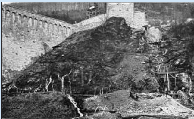
Průsaky v levobřežním zavázání se objevily brzy po prvním napuštění nádrže v roce 1914
