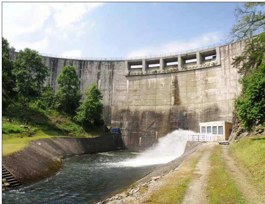
Obr. 2: Klenbová hráz Vrchlice u Kutné Hory, vysoká 40,8 m, s provedenou kontaktní injektáží mezi železobetonovými bloky tělesa (Internet)
