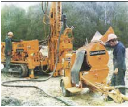
Obr. 6: Typická sestava vrtné soupravy a míchačky s injekční pumpou Putzmeister, používaná pro zhutňovací injektáž menšího rozsahu od roku 1986 britskou firmou Cementation (Cementation)
