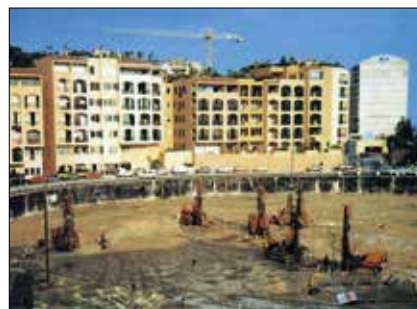
Obr. 7: Hlubinné zvýšení ulehlosti podzákladí z kyprých zemin zhutňovací injektáží na stavbě obytného komplexu v monackém přístavu v roce 1986 (Soletanche)
