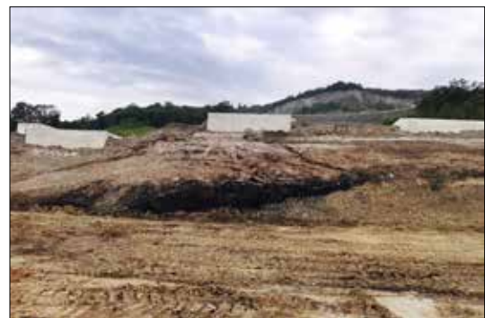
Lokální svahová destabilita během odtěžování tělesa dálnice, již pod zajištěním stat. prvky. V oblasti smykové plochy jsou výrazné vrstvy uhlénoho detritu.
