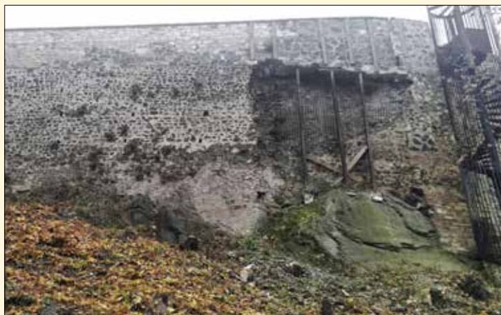
Vysypaná část kamenné přízdivky s provizorním zajištěním v západní části severní zdi (havárie č. 1), (2015)
