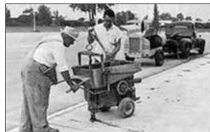
Obr. 4: Oprava betonového chodníku pneumatickým zařízením Koehring-Mudjack s nožovým hnětačem směsi a pístovou pumpou v USA v roce 1939 (Internet)
