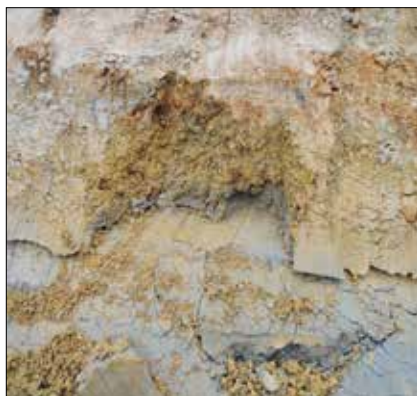
Obnažená smyková plocha během přípravných zemních prací
