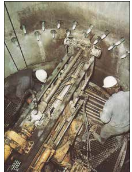
Obr. 8: Vrtání pro injektáž z pomocné šachty k rektifikaci tunelových pecí ve Velkých Opatovicích v roce 1979 (Zakládání staveb, a. s.)
