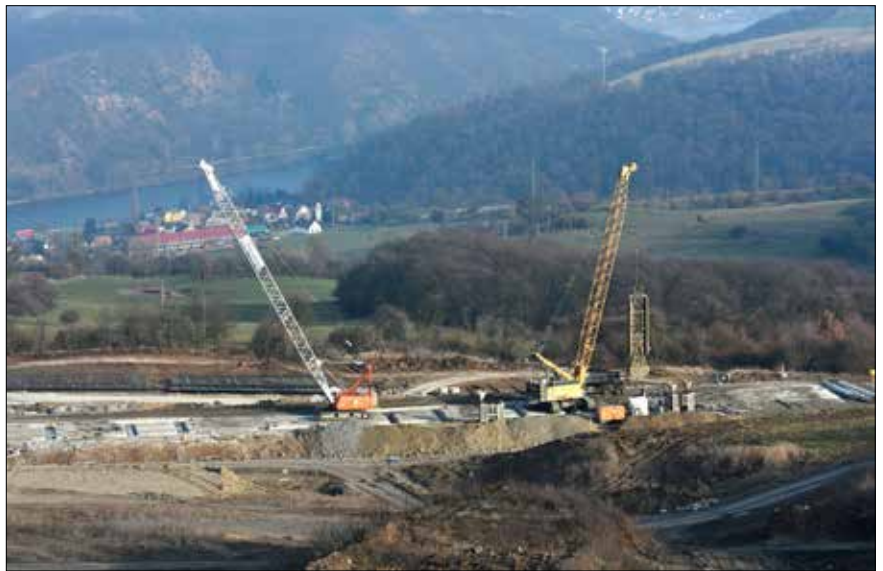
Pohled do údolí Labe během provádění statických prvků z PS, v pozadí obec Litochovice n. L.
