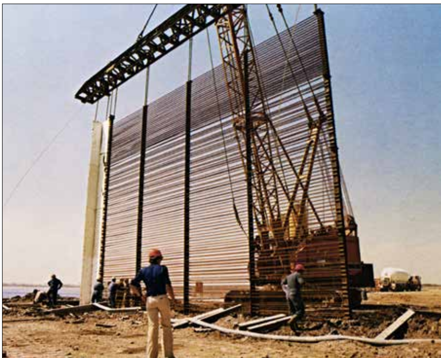
Obr. 6: Kotevní výztuž osazovaná do podzemních jílocementových stěn sloužících pro kotvení nábrežní zdi stavby přístavu v Marseilles-Fos v roce 1988 (Soletanche)
