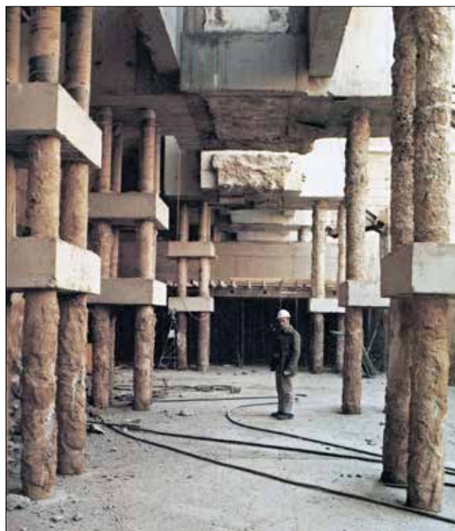
Obr. 5: Vrtané mikropiloty většího průměru, středově vyztužené silnostěnnou injekční trubkou prům. 100 mm s manžetami pro injektáž kořene pro podchycení budov na stavbě stanice Messeplatz vídeňského metra v roce 1981 (StumpBOHR)
