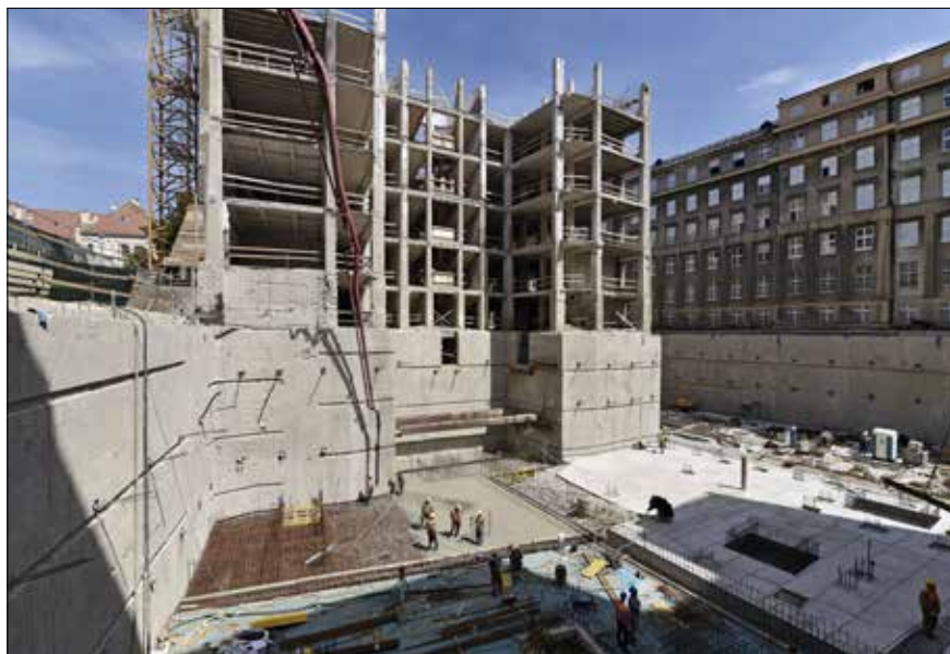
Výstavba základovej dosky podzemných garáží novo dostavovanej časti bloku v ulici Bezručova
