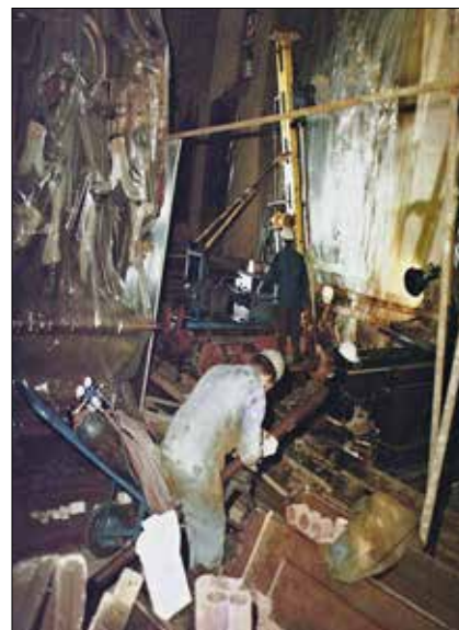
Obr. 2: Vrtání pro mikropiloty 108/14 mm soupravou Wirth BO a příprava jejich instalace uvnitř kostela sv. Michala v Jaroměři v roce 1972 závodem 07 o. p. Vodní stavby (Zakládání staveb, a. s.)
