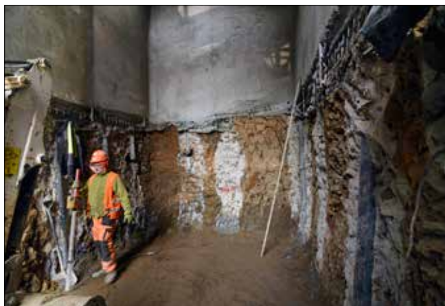
Prohloubení schodišťových stěn až na úroveň – 8,5 m s viditelným pažením sloupy TI
