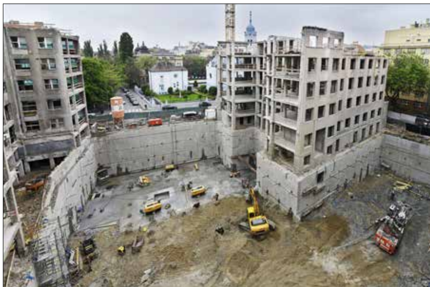
Stavebná jama behom ťažby a kotvenia podzemných stien, pohľad od ulice Lomonosova
