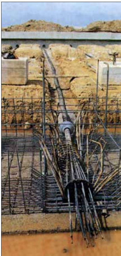
Obr. 7: Ukázka vodorovného protikotvení konstrukcí s předpínáním lanových táhel na stavbě přístavu Bandar Abbas v Iránu v roce 1980 (Trevi)
