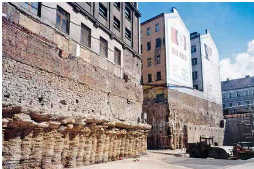
Obr. 13: Zajištění výkopu základové jámy současně s podchycením základů sousedních budov tryskovou injektáží pro výstavbu hotelu Renaissance v Praze v roce 1990 (archiv Zakládání staveb, a. s.)
