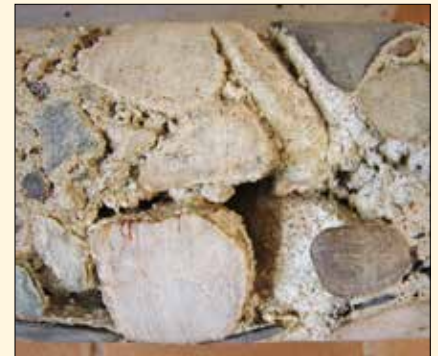
Obr. 11: Ukázky odvrtnů mezerovitého betonu
