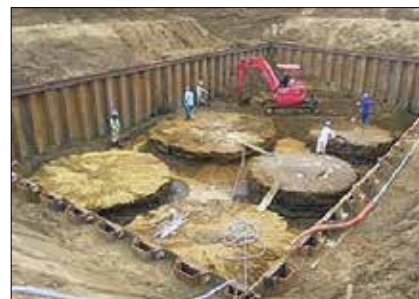
Obr. 14: Zkušební pole se sloupy tryskové injektáže o průměru až 5,5 m, zhotovené inovativním postupem „V-JET Technology“ japonské firmy JBP v roce 2013 (Japan Bosai Platform)
