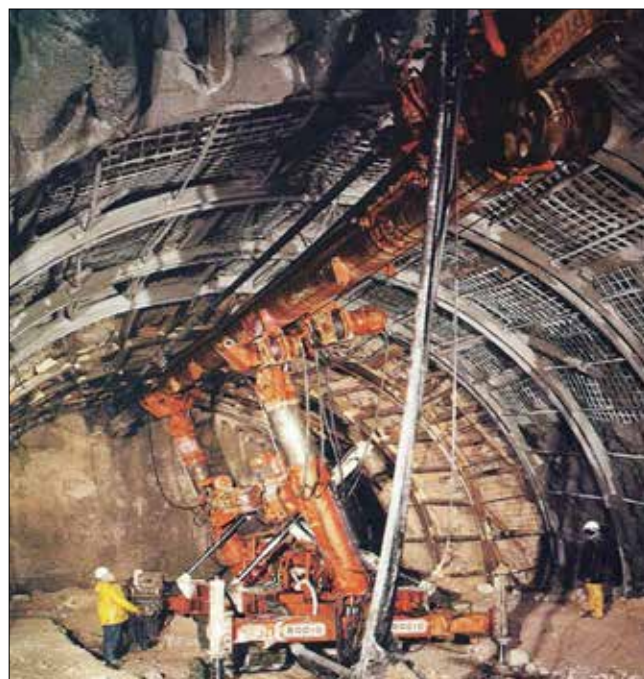
Obr. 11: Zajištění nadloží pro ražbu tunelu Campiolo v roce 1983 pomocí „deštníků“ ze 40 subhorizontálních sloupů jednofázové tryskové injektáže o délce 13m (Rodio)
