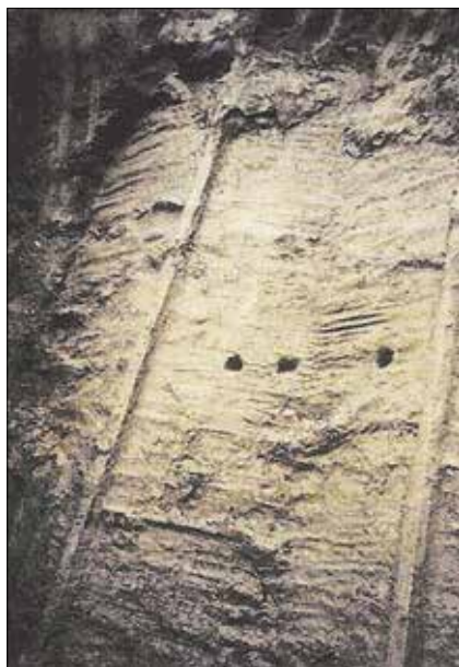
Obr. 12: Výkopem obnažený kontrolní úsek těsnicí stěny z lamel tryskové injektáže v roce 1993. Hloubka stěny byla 7 m, vzdálenost vrtů 3 m, úklon protínajících se lamel 45 a jejich tloušťka 15 až 35 cm (Bachy)
