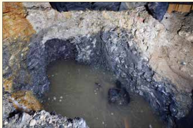
Odhalená základová spára pilíře mostu č. 3 na kontaktu s břidlicí a pod ní vytvořená průzkumná „kapsa“
