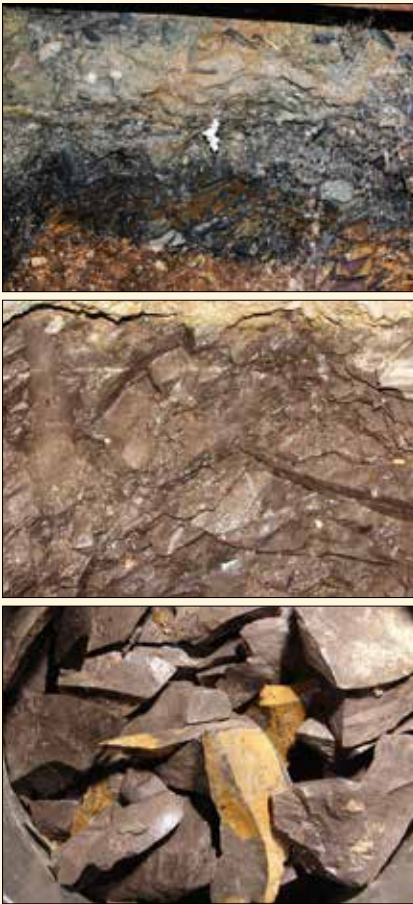
Obr. 6: Nahoře základové poměry u pilíře č. 3, uprostřed detail břidlice skalního podloží, dole břidlice skalního podloží pilíře č. 3 zhruba v místě domnělé základové spáry ve výškové úrovni cca 174,0 m n. m. (12/2016)
