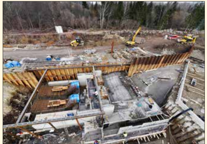
Pohľad do stavebnej jamy zo žeriavu, vľavo osadené sávky v elektrárni, v pravo ochrana stavebnej jamy pilotovou a štetovnicovou stenou
