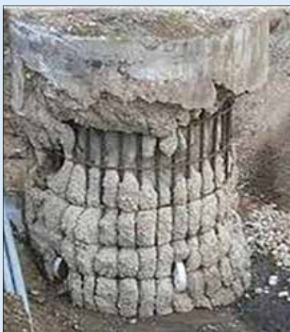
Obr. 2: Ukázka defektu vrtané piloty – zcela nedostatečně vyplněný prostor uvnitř, kolem a vně za výztuží betonovou směsí se špatnou reologií (internet)
