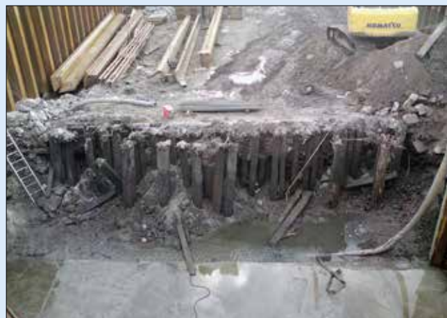
Při těžbě jímky byly odhaleny kolidující původní dřevěné piloty starého jezu, které musely být odstraněny.
