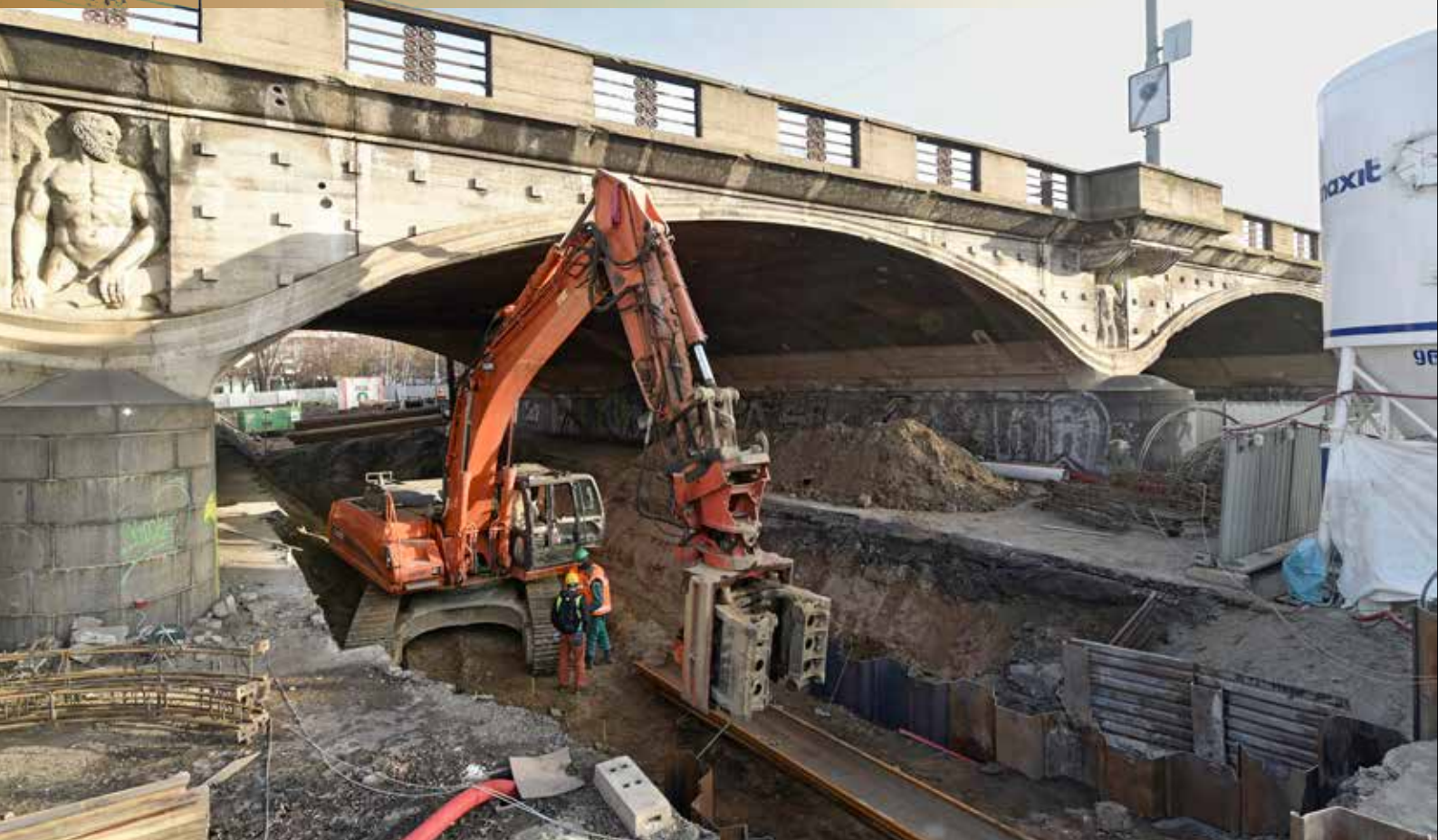
Instalace štětovnic odbočné větve kolektoru Hlávkova mostu ze šachty J103 na ostrově Štvanice pod klenbou mostu za použití beranidla s bočním úchopem MOVAX
