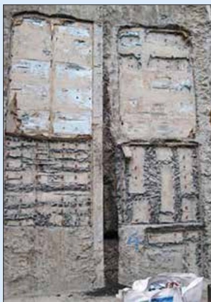
Obr. 7: Porucha na lamelě č. 22 v hloubce 16 m, šachty Whitechapel z podzemních stěn na stavbě podzemní dráhy Crossrail ve Velké Británii v roce 2016 [5]
