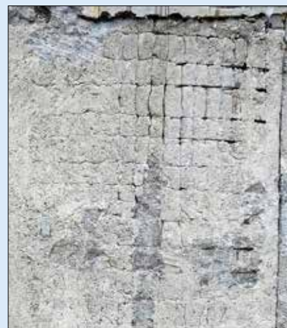
Obr. 3: Ukázka imperfekce podzemní stěny – matracovitý vzor povrchu betonu zapříčiněný nedostatečným průnikem směsi přes armokoš a špatným obalením prutů výztuže (archiv autora)
