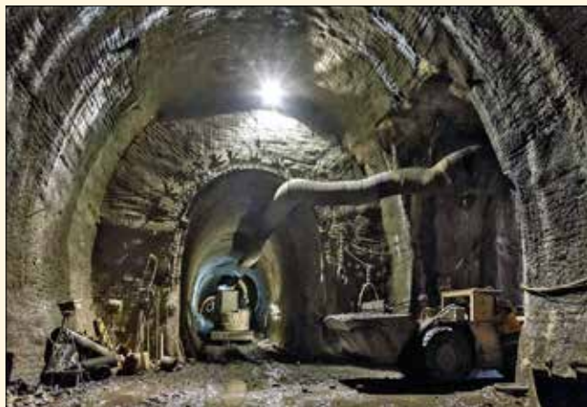
Pohled z technické komory TK103 do kolektorové trasy a propoje se šachtou J103
