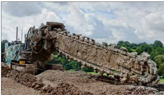
Obr. 8: Řetězová fréza typu FMI pro soil-mixing německé firmy Allcon na akci stabilizace železničního tělesa St. Wendel do hloubky 9 m při tloušťce 0,5 m v roce 2014 (Allcon Maschienbau GmbH)
