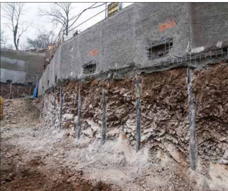
Mikrozápory na severní stěně po odkopání
