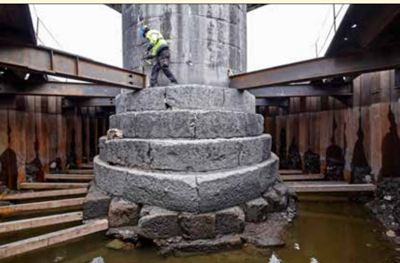
Obnažená základová konstrukce pilíře P2 uvnitř dvojité štětové jímky před zahájením sanačních prací, SO 14-14
