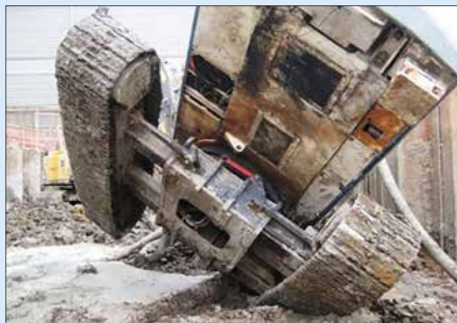
Obr. 1: Typická nehoda převrácení zakládací soupravy v důsledku zaboření podvozku do nedostatečně pevné pracovní plochy
