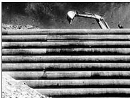
Obr. 9: Budování první konstrukce z vyztužené zeminy ve francouzském Pragnières v roce 1965 (Terre Armée)
