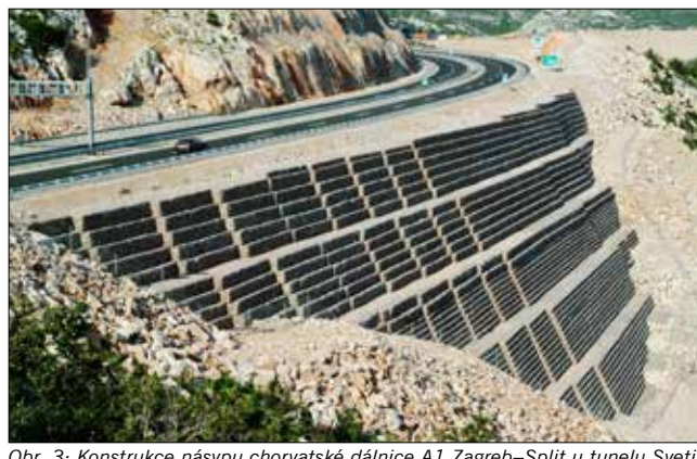
Obr. 3: Konstrukce násypu chorvatské dálnice A1 Zagreb–Split u tunelu Sveti Rok ze zemin vyztužené v roce 2001 systémem Terramesh s gabiony o celkové výšce 30 m (maccaferri.sk)
