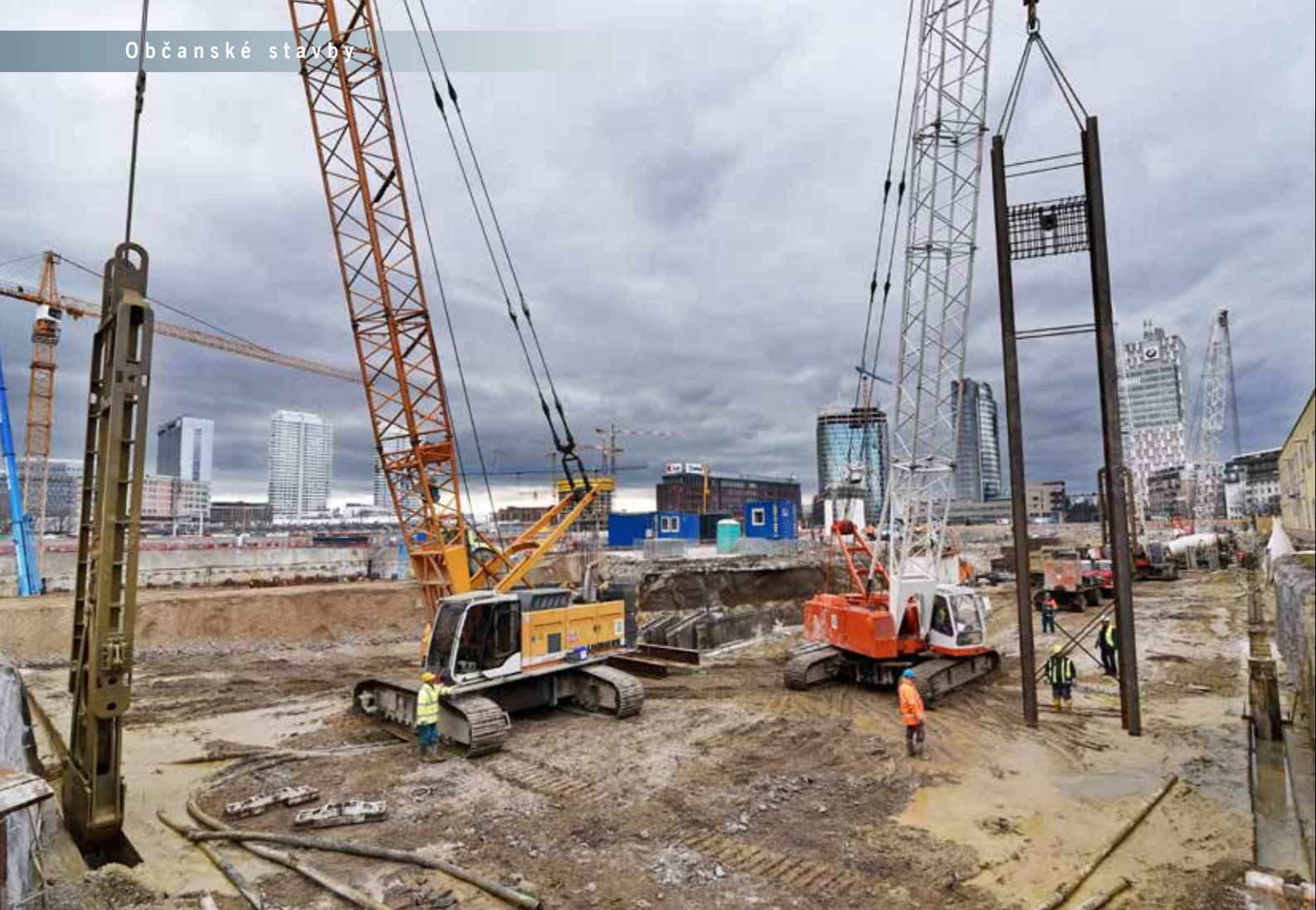
Ťažba ryhy pre podzemnú stenu a príprava na osadzovanie výstužných panelov z profilov IPE
